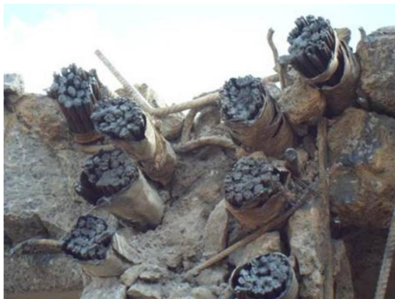
Figura 03 – Cabos e cordoalhas sem indícios de nata de cimento injetada
