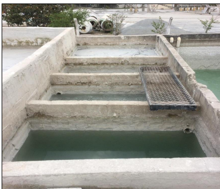
Figura 3.5 - Decantadores para obtenção de agregados reciclados de lama residual de concreto usinado
