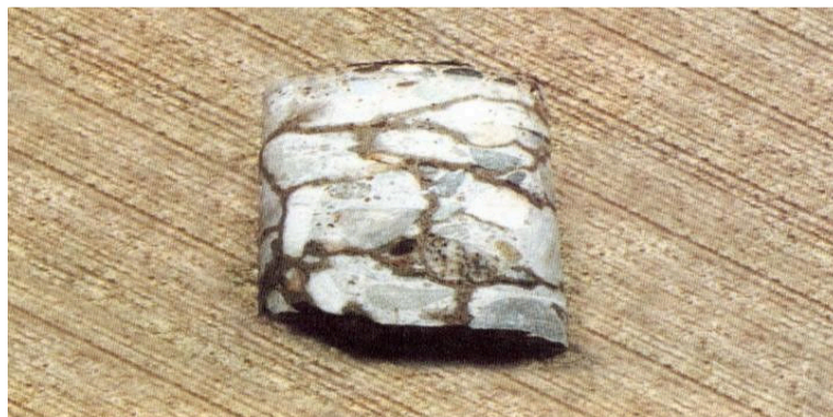
Figura 8: Fissuras causadas por ataques de sulfatos. Fonte: THOMAZ apud AGUIAR, 2016.
