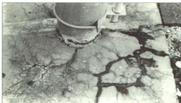
Figura 9: Fissuração na base do concreto armado, de uma torre de rede elétrica. Fonte: AGUIAR, 2016.
