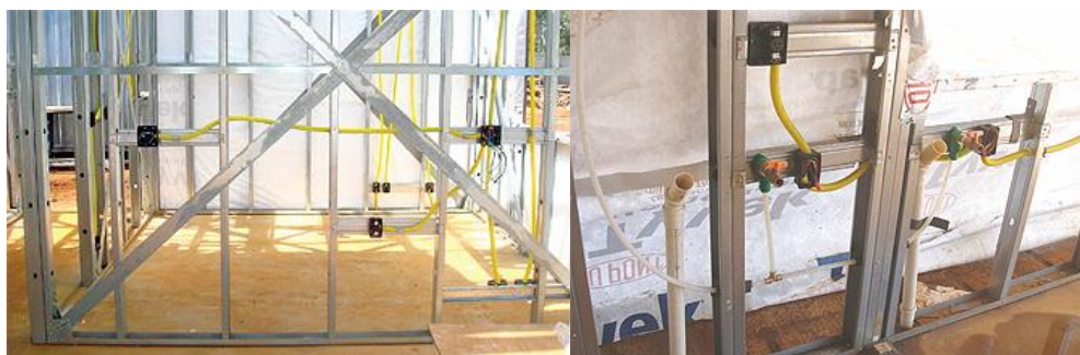
Figura 21 – Instalações hidráulicas e elétricas de uma estrutura do tipo LSF. Fonte: www.techne17.pini.com.br
