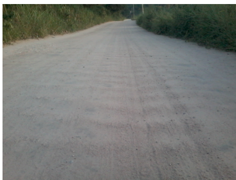
Figura 14: Corrugações em pavimento
