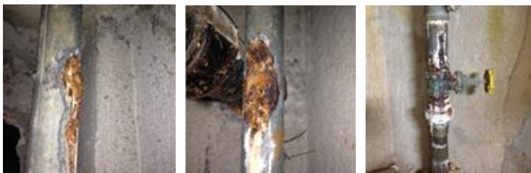
Figura 16: Tubulação da prumada de água em estado de corrosão.
