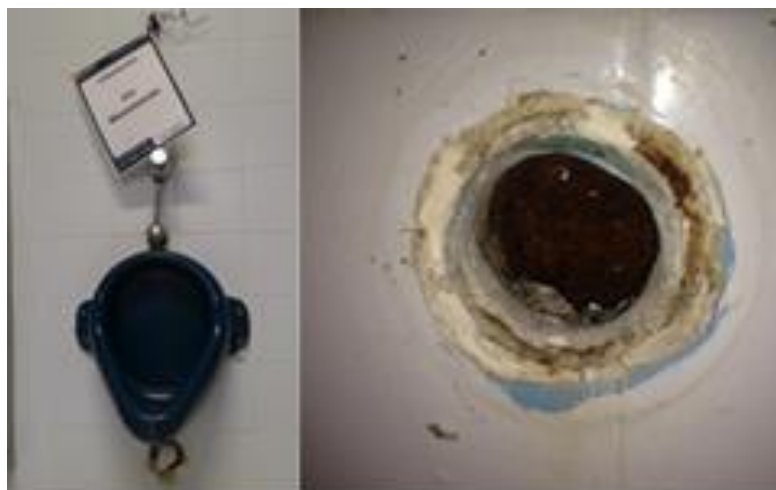
Figura 17: Tubulação de esgoto com oxidação interna.
