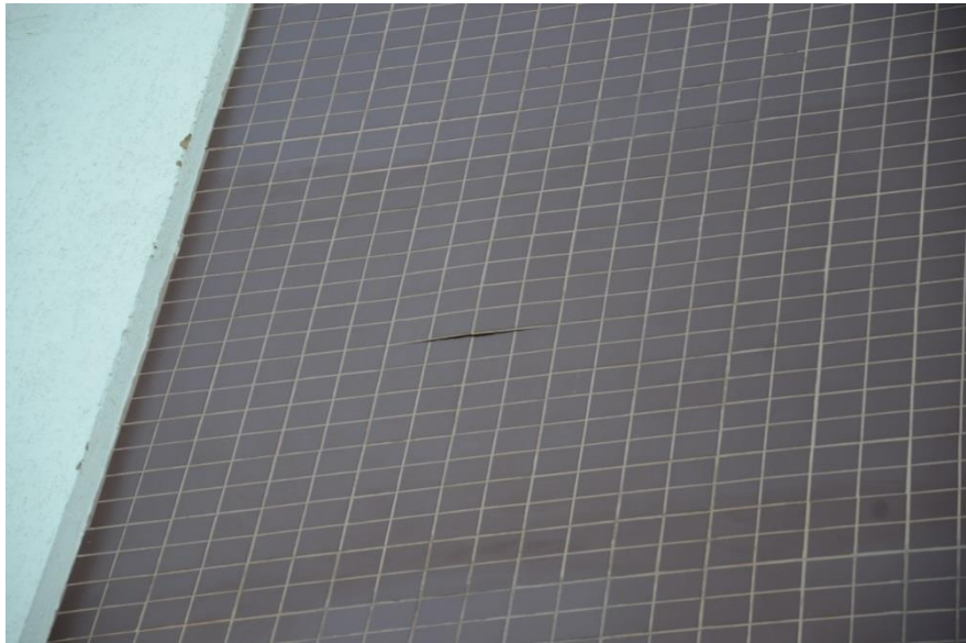
Figura 32: Estufamento encontrado nos andares inferiores.
