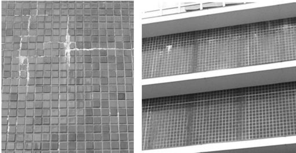
Figura 25: Eflorescências na fachada de um edifício.
