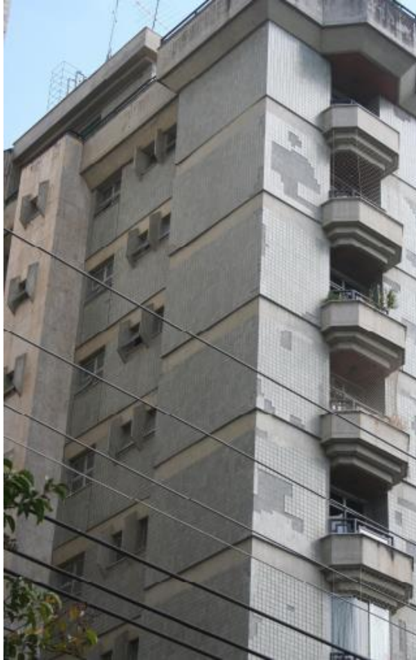
Figura 23: Destacamento das placas cerâmicas.
