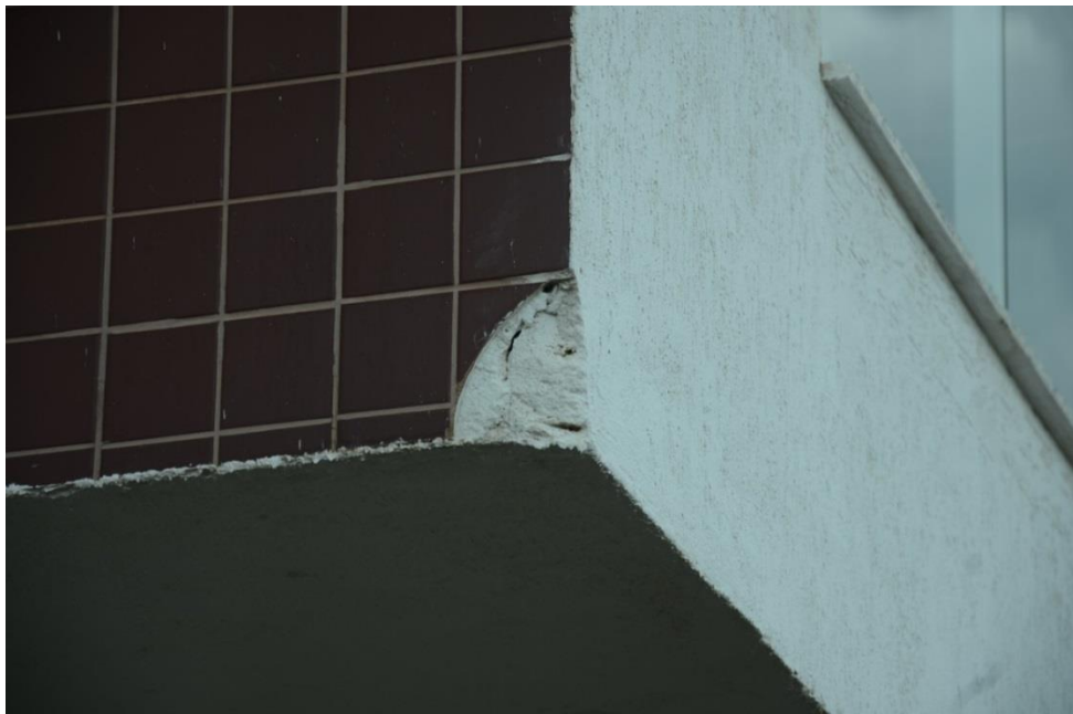
Figura 31: Quina afetada da fachada. Fonte: Arquivo Pessoal.
