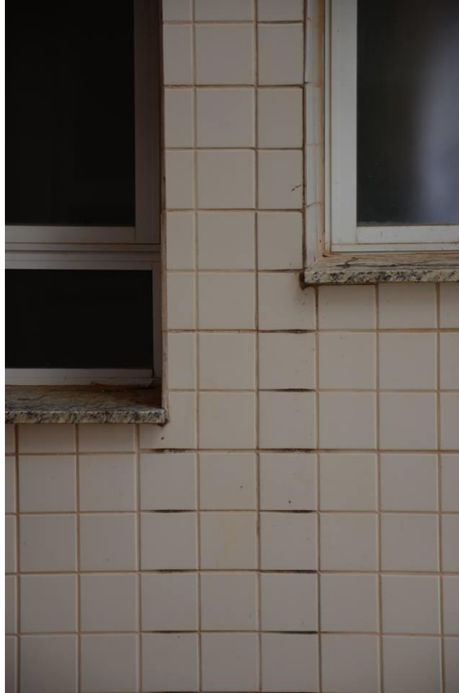
Figura 39: Manchamento abaixo das esquadrias Fonte: Arquivo pessoal
