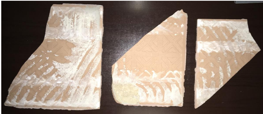
Figura 37: Tardoz das cerâmicas que se soltaram da fachada.
