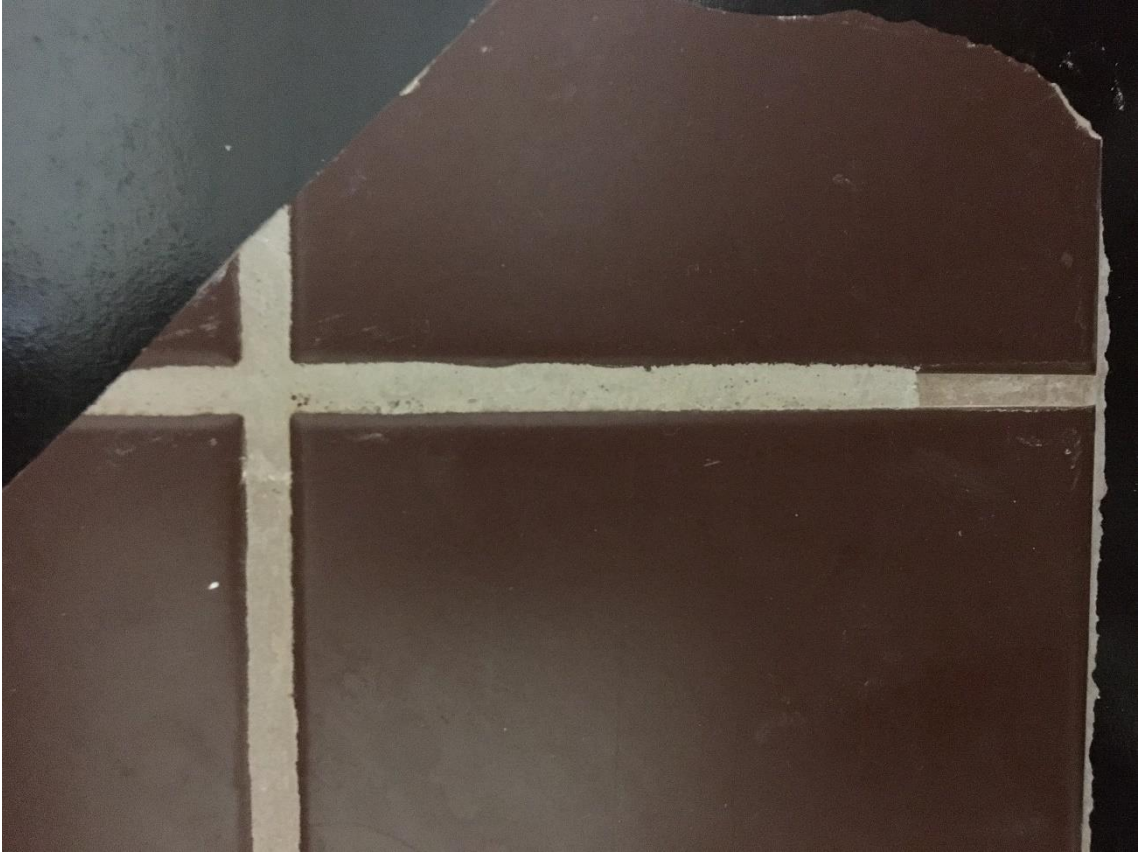
Figura 38: Rejunte na parte central da placa cerâmica. Fonte: Arquivo Pessoal.
