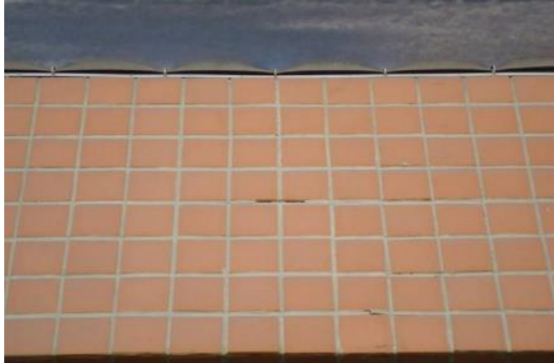
Figura 24: Deterioração das juntas.
