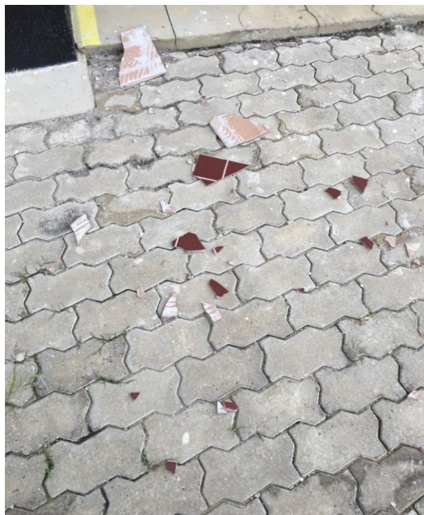
Figura 36: Cerâmicas que se soltaram da fachada. Fonte: Arquivo Pessoal.
