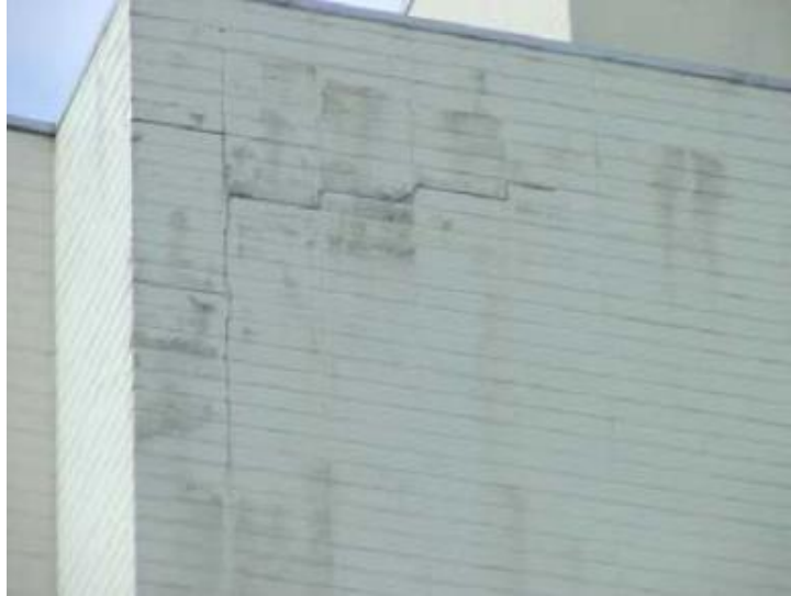
Figura 27: Trincas na fachada.
