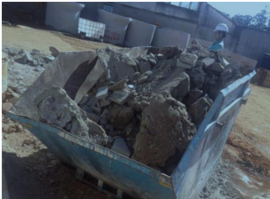
Figura 11: RCC, entulho, Condomínio Spazio Treviso. Fonte: MRV, 2016.
