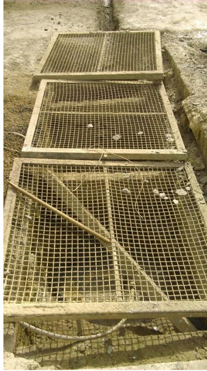
Figura 2: Tanques de decantação de água. Fonte: Arquivo Pessoal, 2016.
