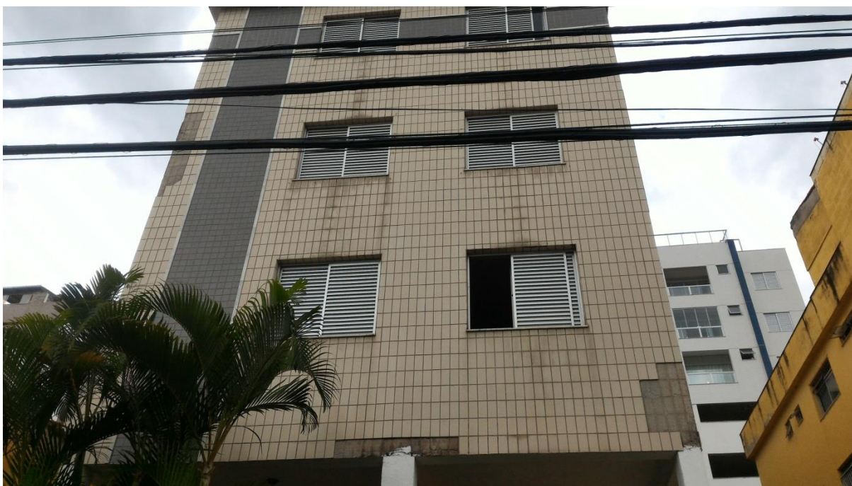
Figura 18 – Desplacamento em vários pontos em fachada externa
