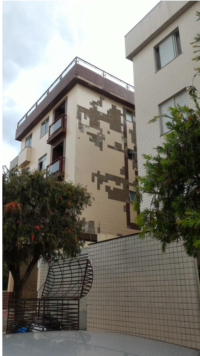
Figura 14 – Destacamento generalizado em fachada
