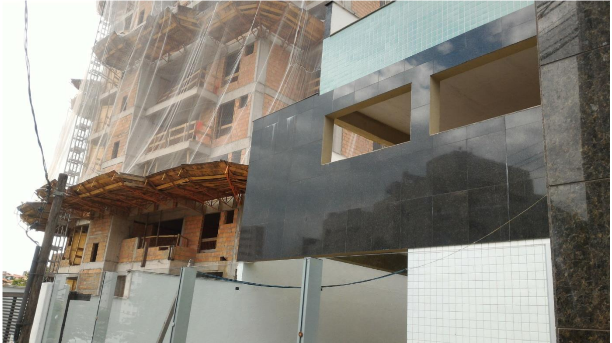
Figura 09: Eflorescência em revestimento externo
