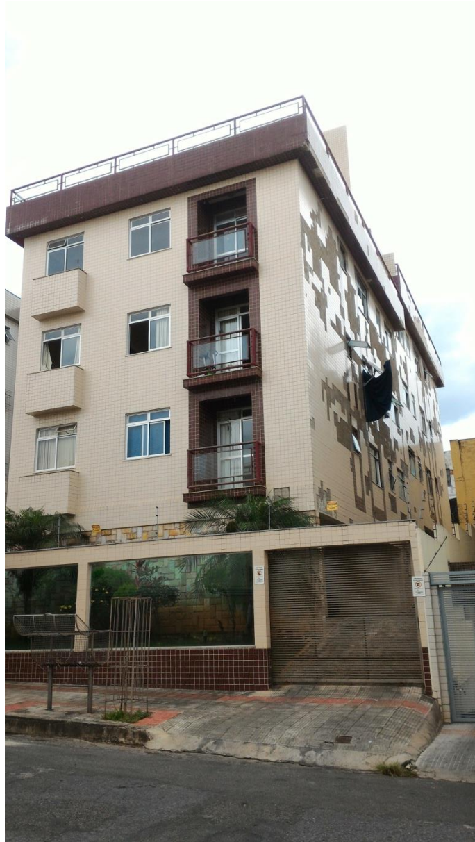
Figura 16 – Destacamento de revestimento cerâmico em fachada
