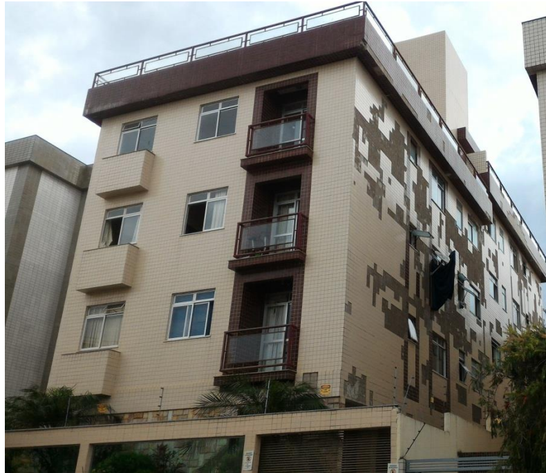
Figura 15 – Deslocamento de revestimento cerâmico em fachada
