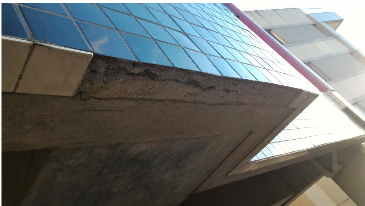
Figura 12 – Destacamento em revestimento cerâmico em viga
