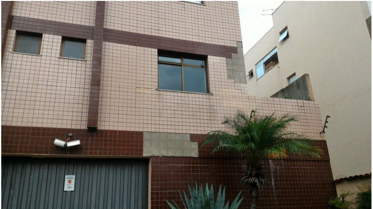
Figura 19 – Destacamento de revestimento cerâmico em fachada
