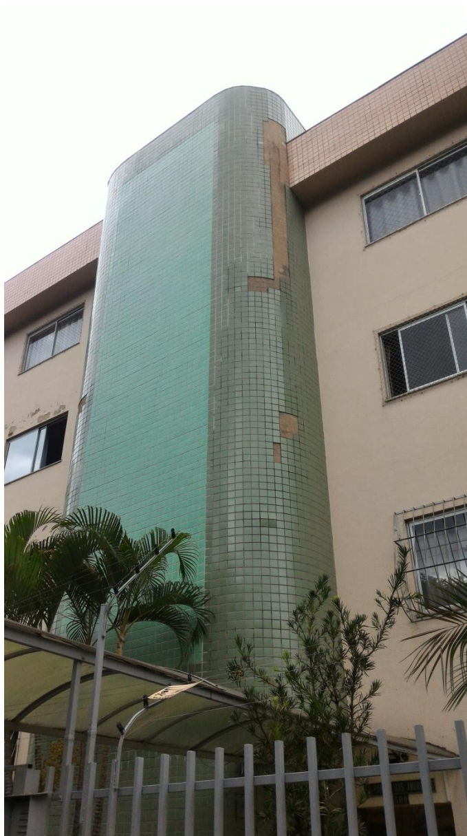
Figura 21 – Deslocamento de material cerâmico em fachada
