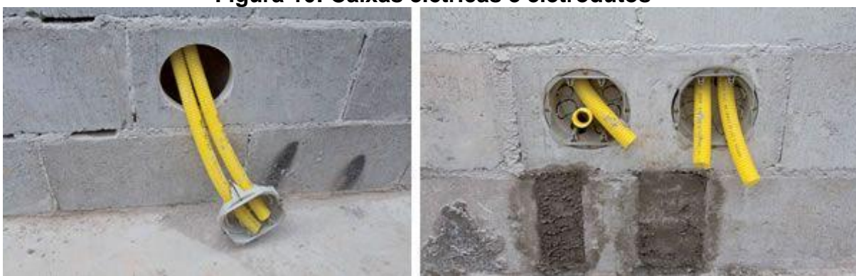
Figura 10: Caixas elétricas e eletrodutos
