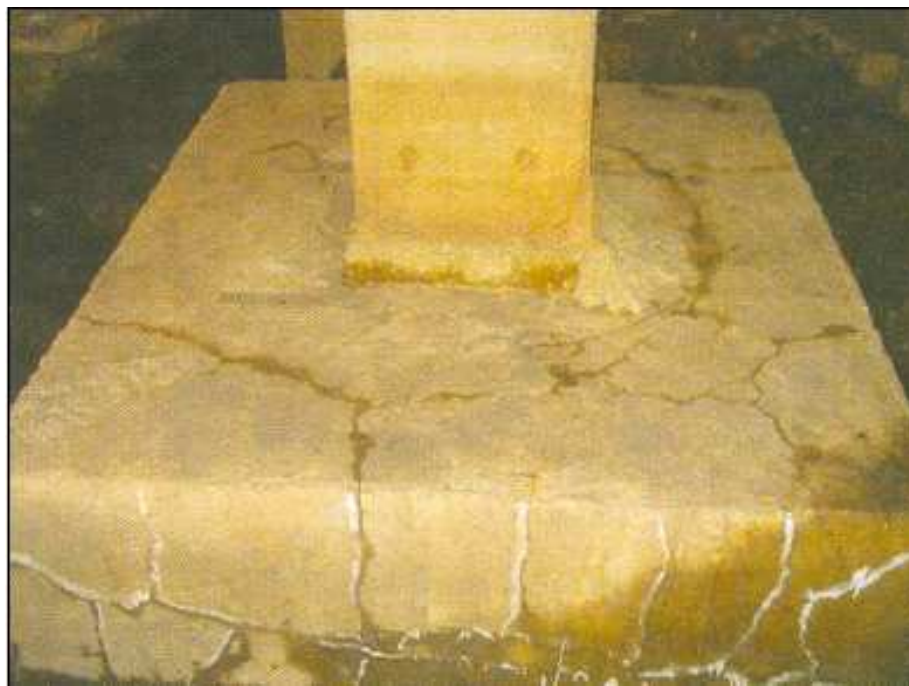
Figura 3:4 - Fissuras em blocos de fundação devido a reação álcali-agregado Fonte: AGUIAR, 2006
