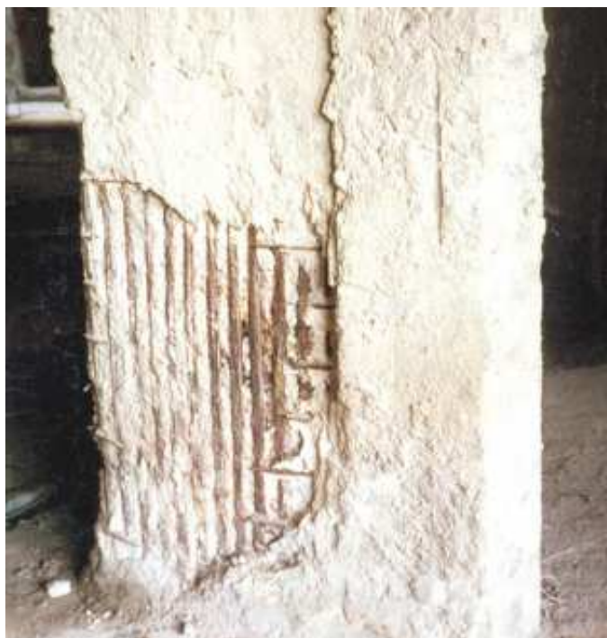
Figura 3:3 - Pilar com corrosão nas armaduras devido à carbonatação Fonte: AGUIAR, 2006
