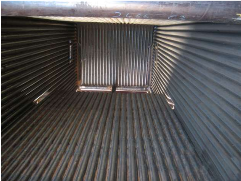
Figura 9 - Tubos que compõem a parede d'água (WTE, 2009).
