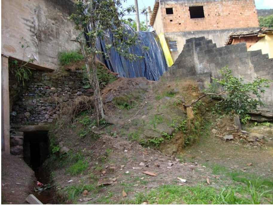
Figura 8: Entrada da galeria subterrânea na parte inferior à esquerda do muro propenso a desabar, ano de 2010.
