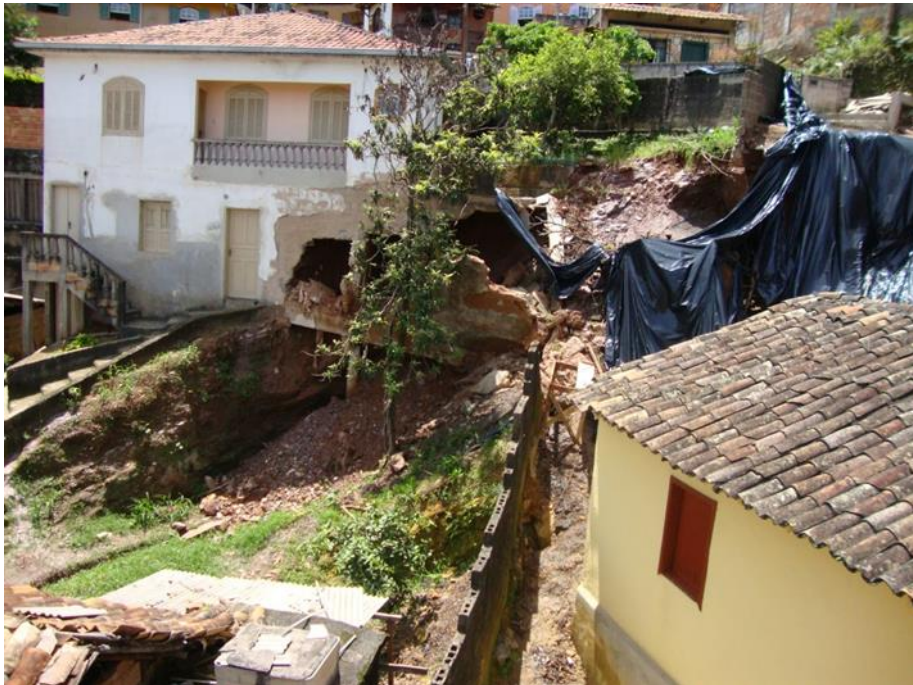
Figura 9: Obstrução da entrada da galeria subterrânea pós-desabamento de muro, ano de 2010.
