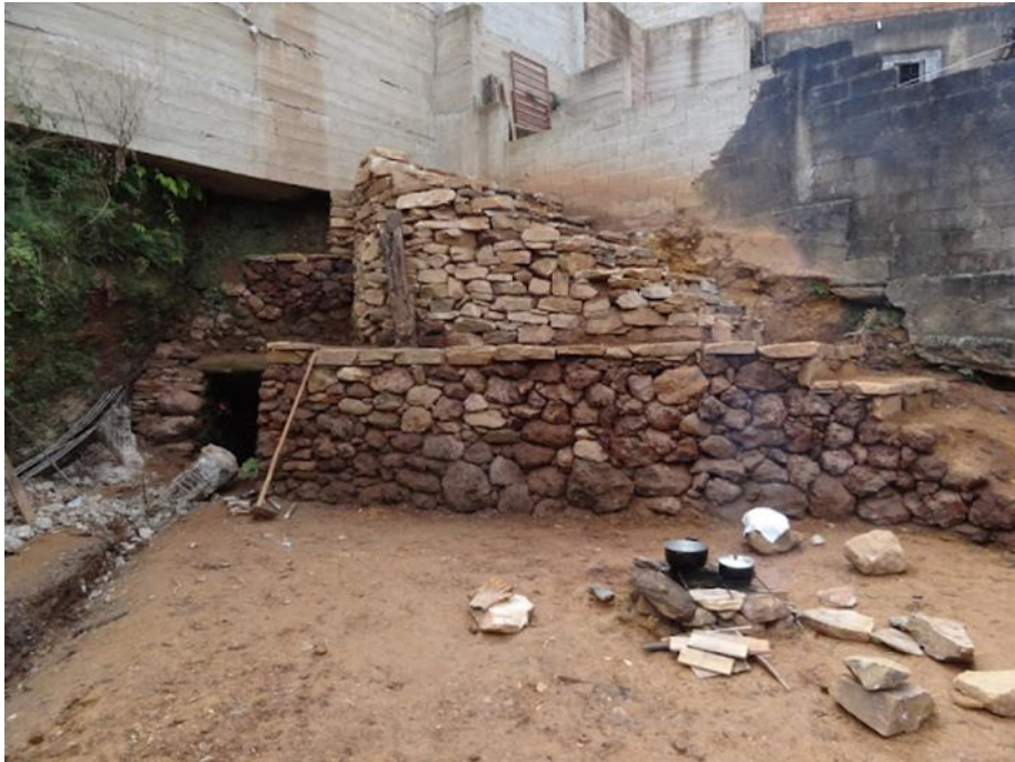
Figura 10: Reconstrução do muro, desobstrução da entrada da galeria e construção de anfiteatro, sem data.
