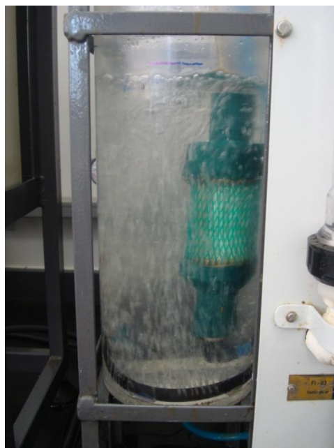
Figura 4.2 – Fotografia do sistema de aeração para o tanque biológico e para a membrana do BRM convencional
