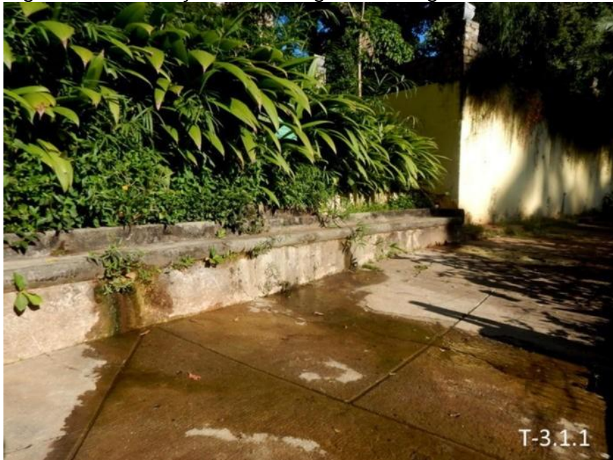
Figura 28 – Indicação de ressurgência de água no transecto 3
