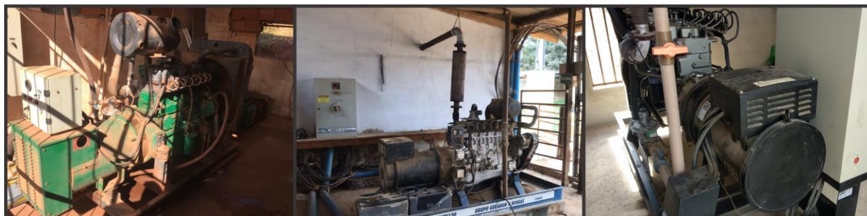
Figura 51 Geradores de energia elétrica instalados nas fazendas visitadas
