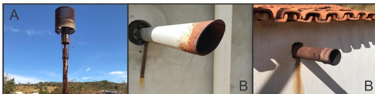
Figura 52 A) Queimador de gás; B) sistemas de exaustão dos geradores
