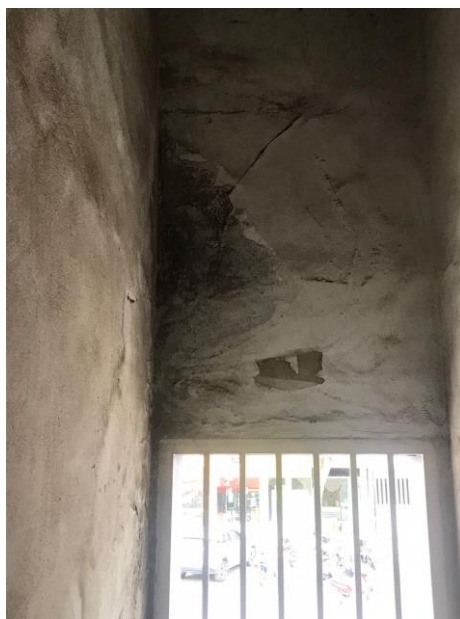
Figura 9 – Manchas de mofo (corredor de entrada)
