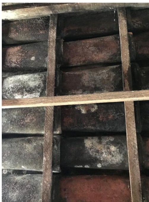
Figura 12 – Mofo e bolor em telhado (setor de revelação)
