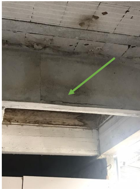
Figura 15 – Trinca em viga (acesso ao estoque)
