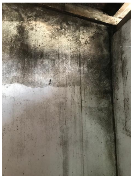
Figura 10 – Mancha de mofo e bolor (setor de revelação)
