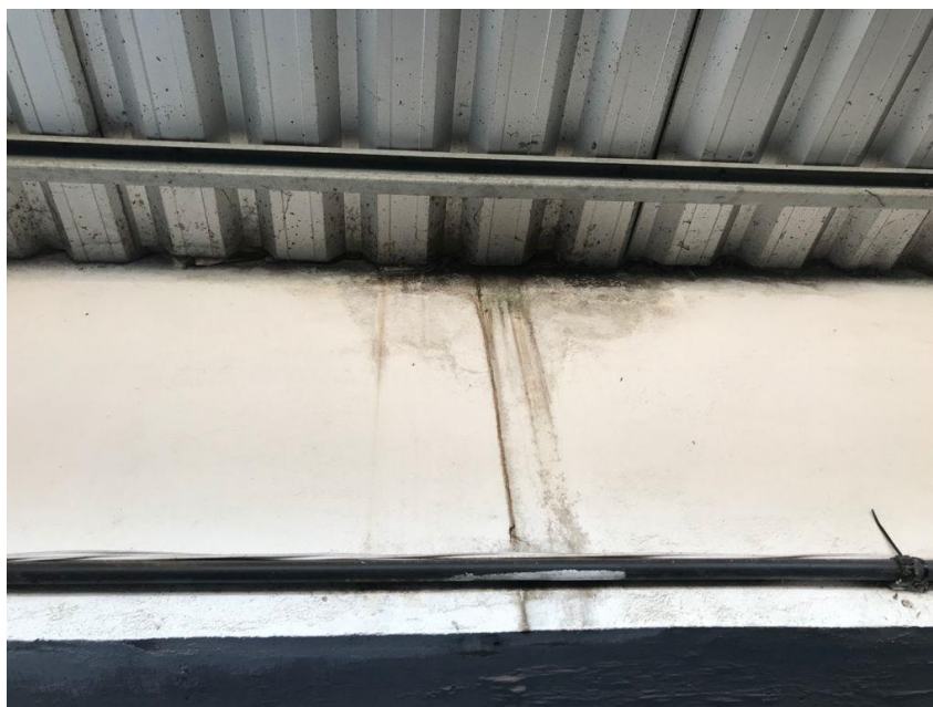
Figura 11 – identificação de mofo e bolor (setor de serigrafia)
