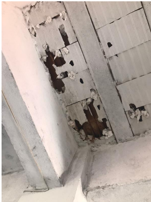
Figura 16 – Deterioração de bloco cerâmico da laje (setor de corte)
