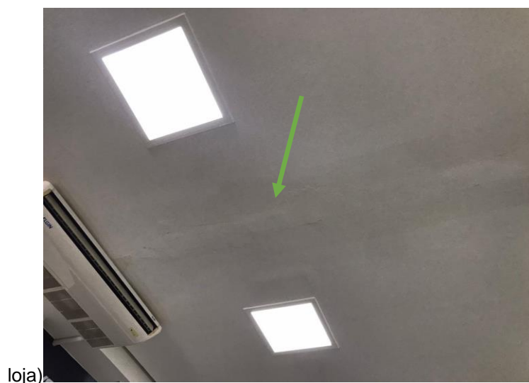
Figura 18 - Trinca em forro de Gesso (interior da
