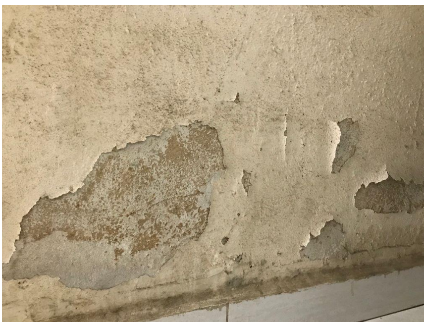
Figura 13 – Descascamento da pintura (corredor de acesso a produção)
