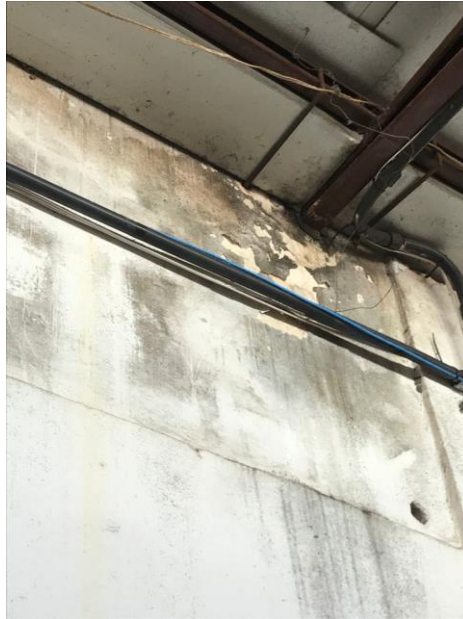
Figura 14 – Descascamento da pintura (setor de estampa)
