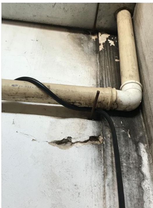
Figura 17 – Ocorrência de deslocamento de reboco (setor estampa)
