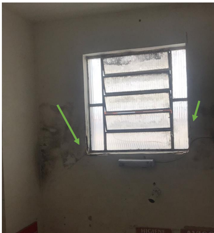
Figura 19 – Trinca em janela (corredor de acesso à produção)
