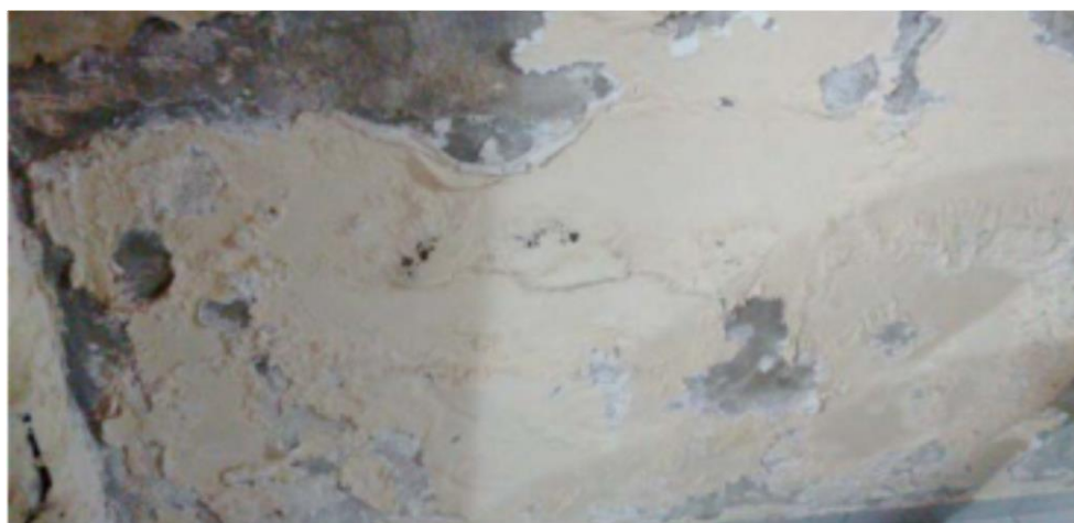
Figura 6 - – Parede com eflorescências.
