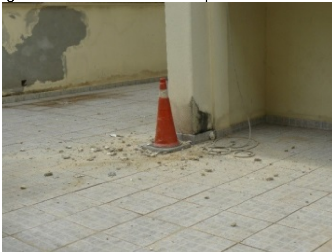
Figura 34 – Revestimento Desprendido do substrato
