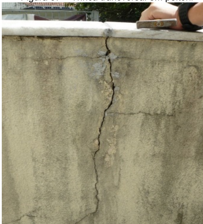
Figura 37 – Trinca transversal em peitoril
