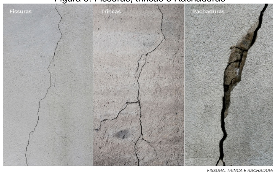
Figura 5: Fissuras, trincas e Rachaduras
