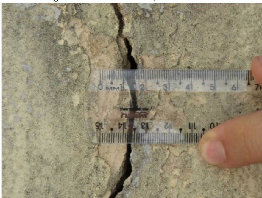
Figura 38 – Medida da espessura da trinca
