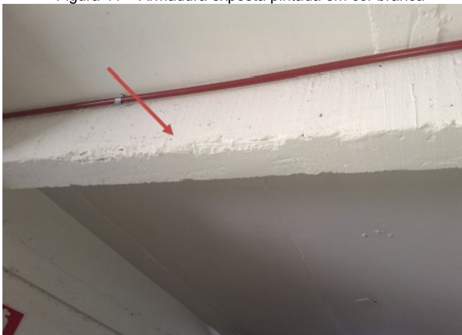
Figura 41 – Armadura exposta pintada em cor branca
