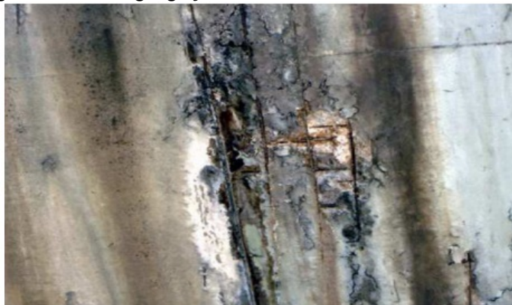
Figura 23: Desagregação da estrutura de concreto armado
