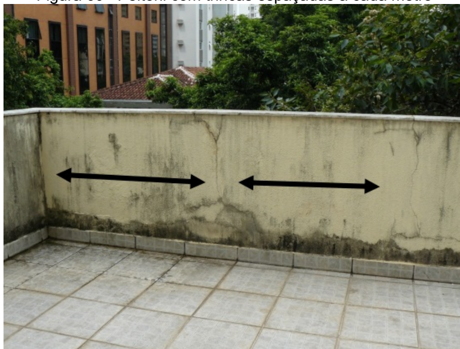
Figura 60– Peitoril com trincas espaçadas a cada metro
