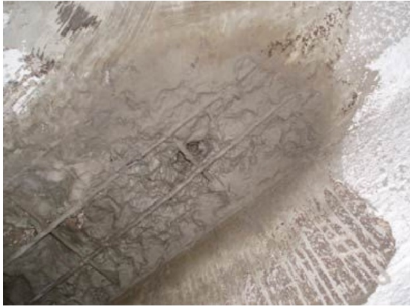
Figura 22: Segregação em estrutura de concreto armado
