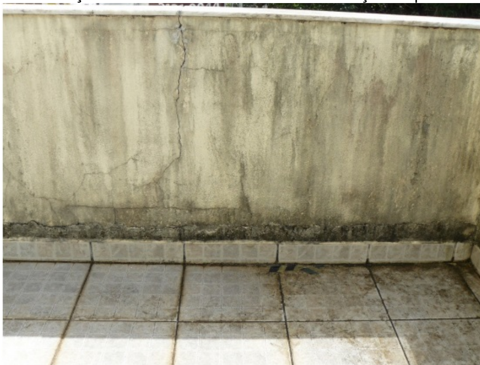
Figura 61 – Presença de trinca com indícios de movimentação no peitoril em balanço
