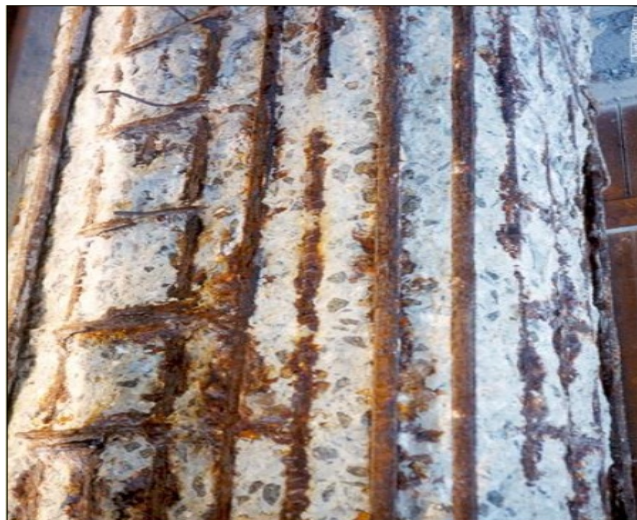
Figura 18: Pilar deteriorado devido aos efeitos da interação da carbonatação com íons cloretos
