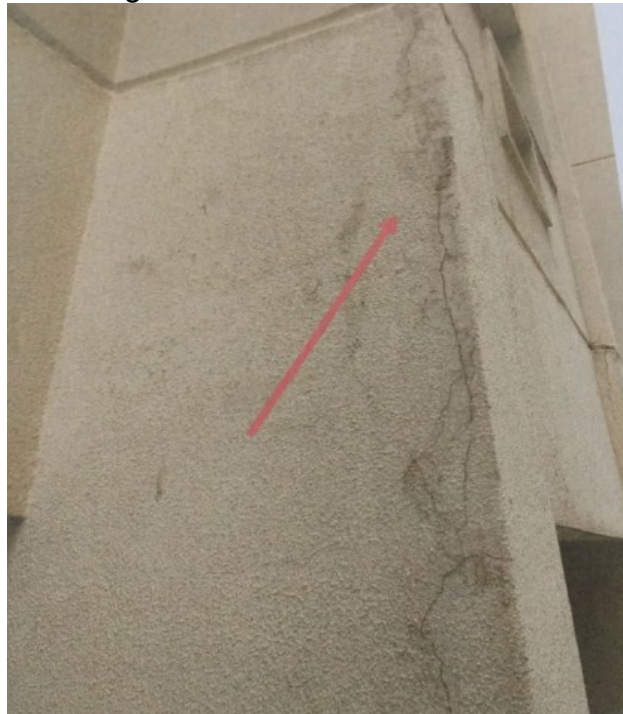
Figura 36 - Pilar com rachaduras
