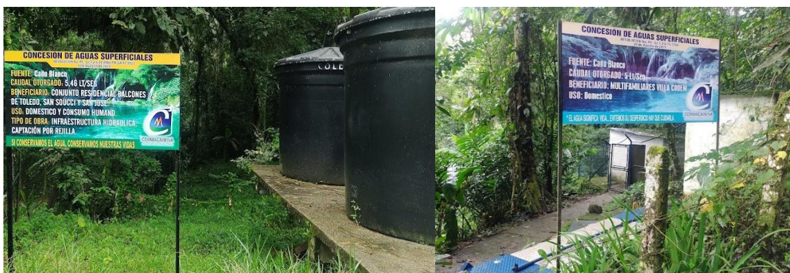
Figura 24: Captaciones de agua de condominios cerrados en Villavicencio
