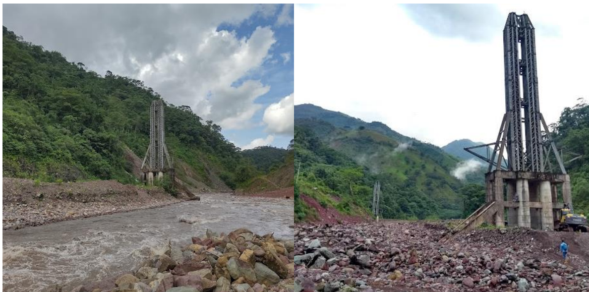
Figura 22: Torres construidas por EDESA para crear una línea de aducción elevada sobre el río Guatiquía
