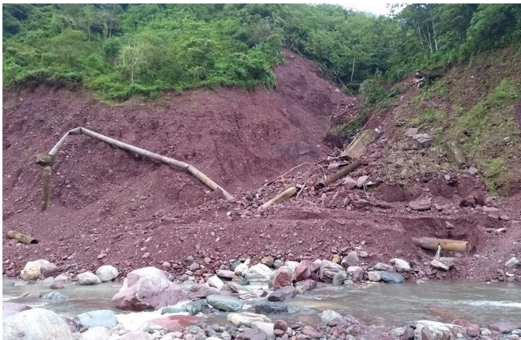
Figura 21: Daños por deslizamientos de tierra sobre tubería elevada de la línea de aducción del sistema de Quebrada Honda
