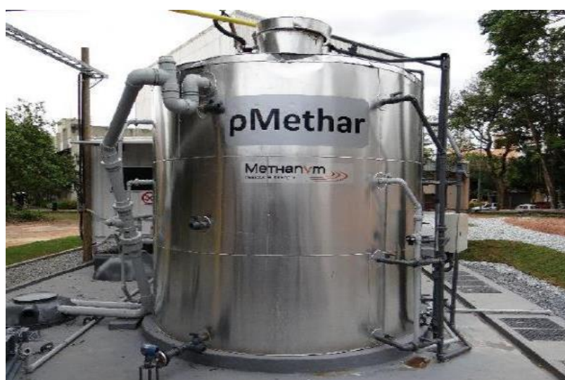
Figura 16- Reator de metanização de resíduos orgânicos da UFMG
