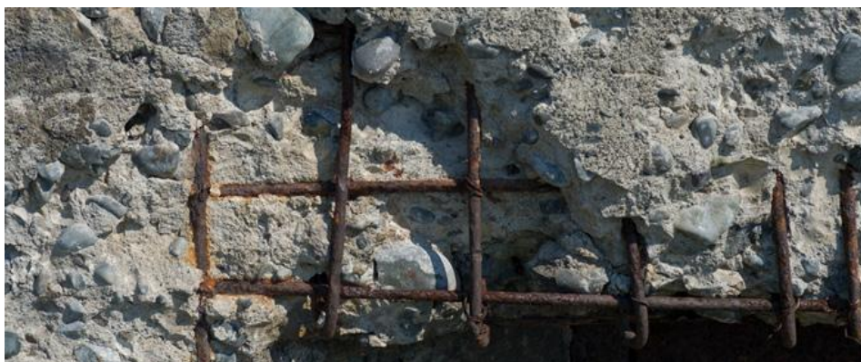
Figura 09: Bicheira na estrutura de concreto
