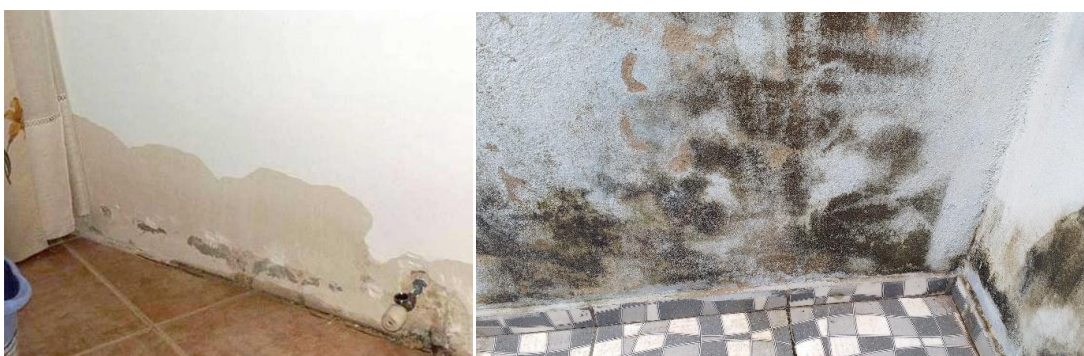
Figura 05: Manchas ocasionadas por umidade
