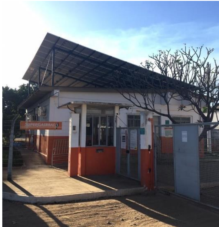
Fotografia 1 – SFV 24 kWp – Governador Valadares/MG
