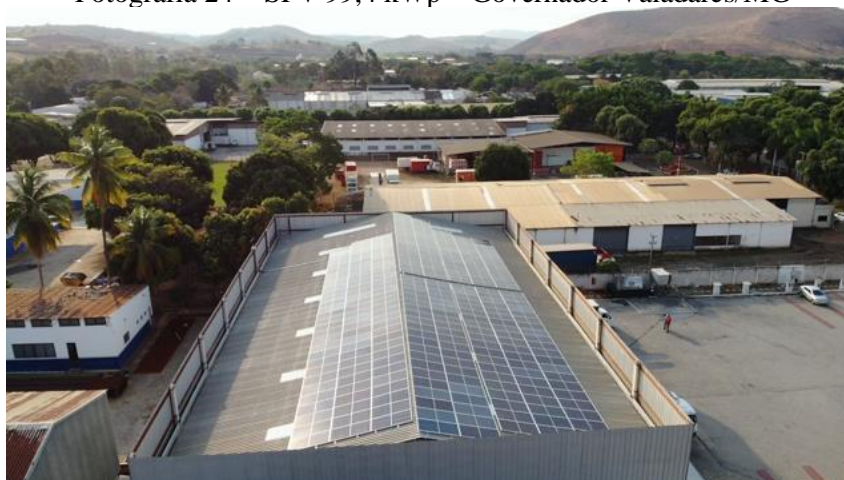
Fotografia 24 – SFV 99,4 kWp – Governador Valadares/MG
