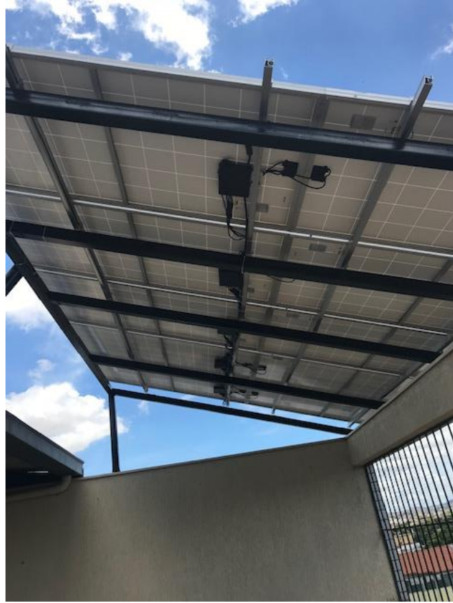
Fotografia 7 – SFV 3,25 kWp – Governador Valadares/MG
