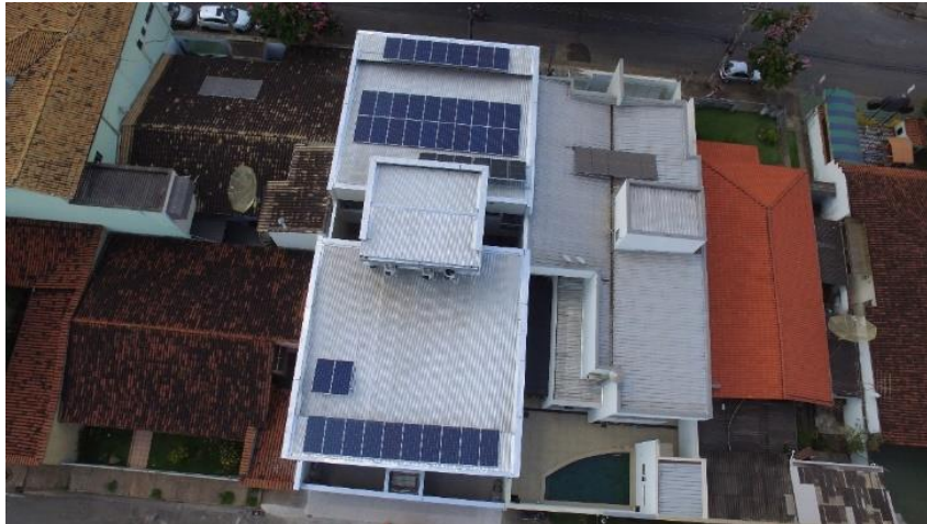
Fotografia 10 – SFV 12,8 kWp – Ipatinga/MG
