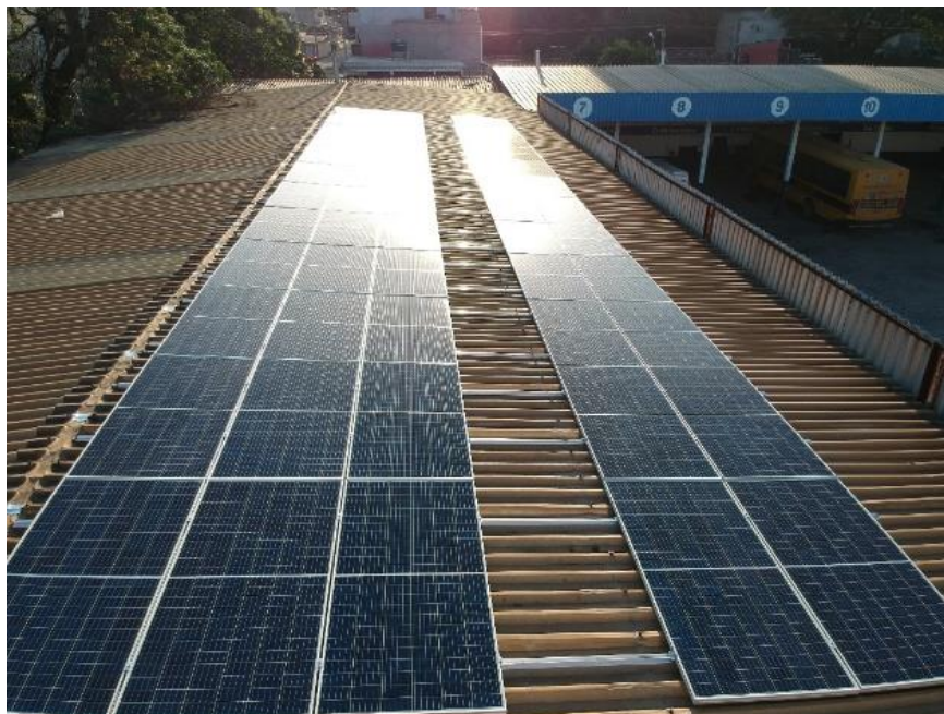
Fotografia 14 – SFV 21 kWp – Governador Valadares/MG
