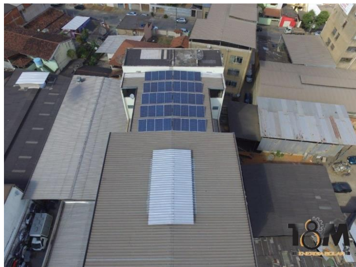
Fotografia 18 – SFV 10 kWp – Ipatinga/MG
