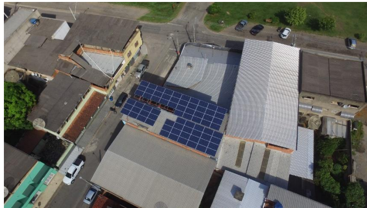
Fotografia 17 – SFV 19,25 kWp – Ipatinga/MG
