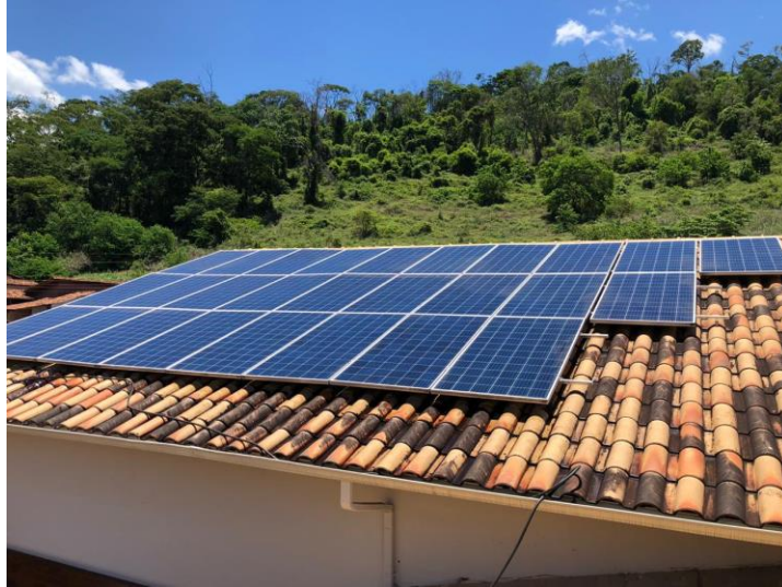
Fotografia 21 – SFV 12,06 kWp – Timóteo/MG
