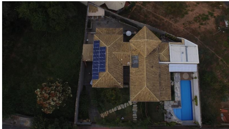
Fotografia 11 – SFV 5,94 kWp – Belo Horizonte/MG
