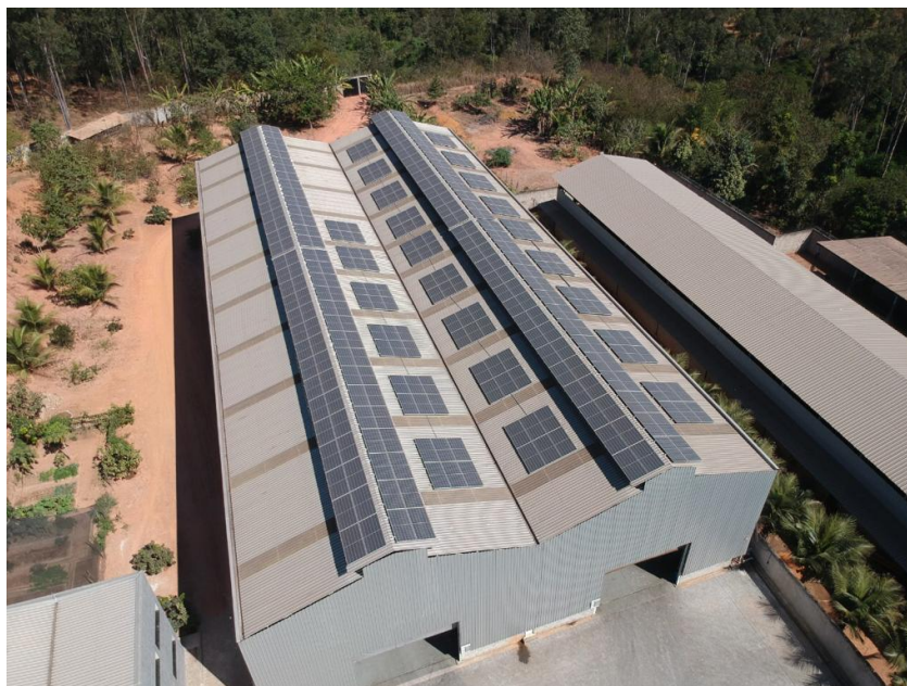
Figura 21 – Sistema fotovoltaico instalado em telhado em uma indústria de Minas Gerais
