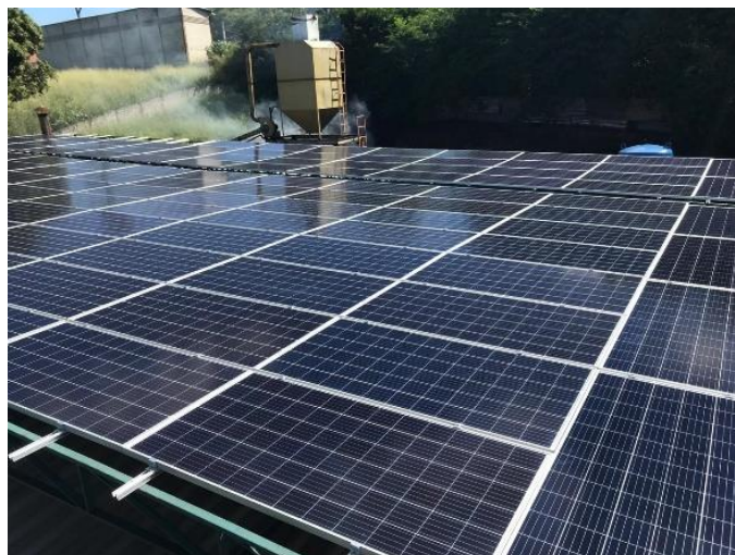
Fotografia 5 – SFV 21,78 kWp – Ipatinga/MG
