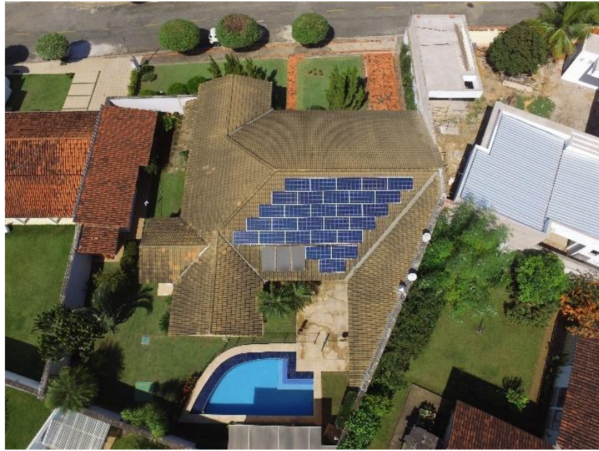
Fotografia 13 – SFV – 8,2 kWp – Ipatinga/MG
