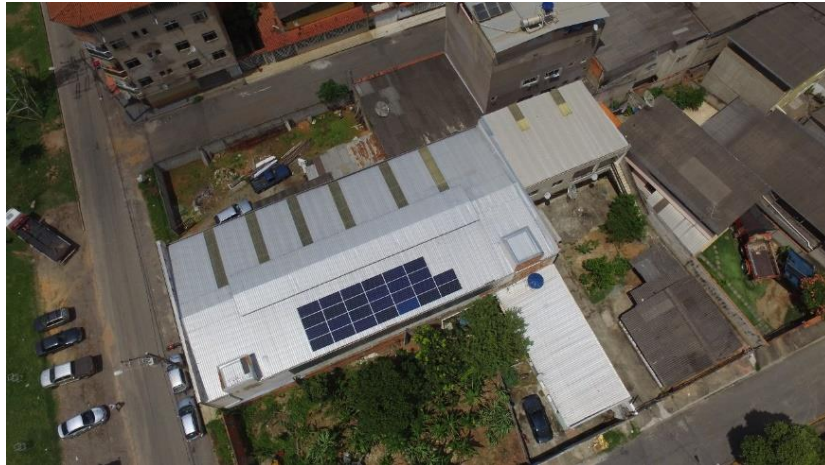
Fotografia 20 – SFV 8,32 kWp – Ipatinga/MG
