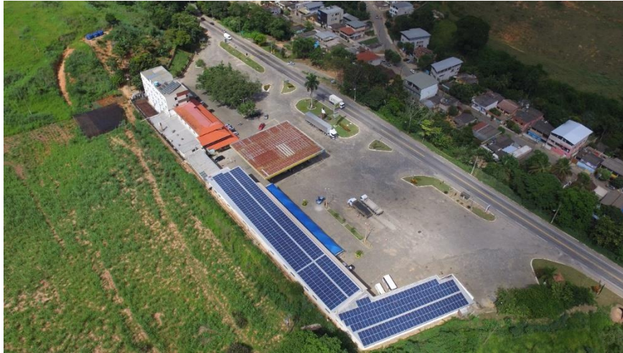
Fotografia 25 – Na foto estão representados os dois sistemas de 87,33kWp com inversores GoodWe, instalados no mesmo local e monitorados separadamente – Naque/MG
