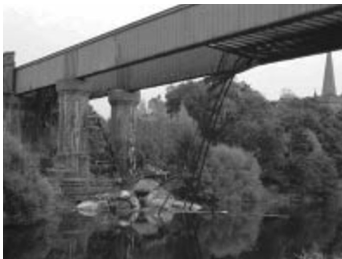
Figura 1-4 – Colapso do viaduto Cahir em 2003 na Irlanda
