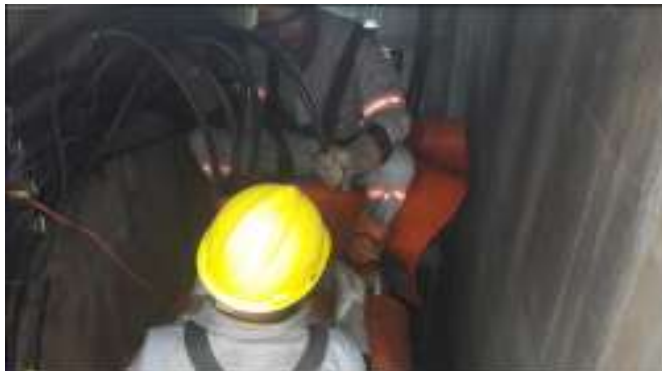
Figura 16. Trabalhador sentado no transformador
