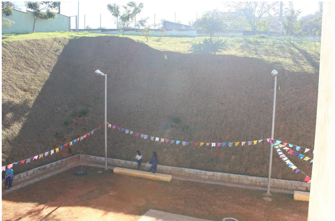
Figura 3 - Foto tirada do segundo andar da UMEI Periquitos. É possível ver a grande área que fica sem uso por ser inclinada.
