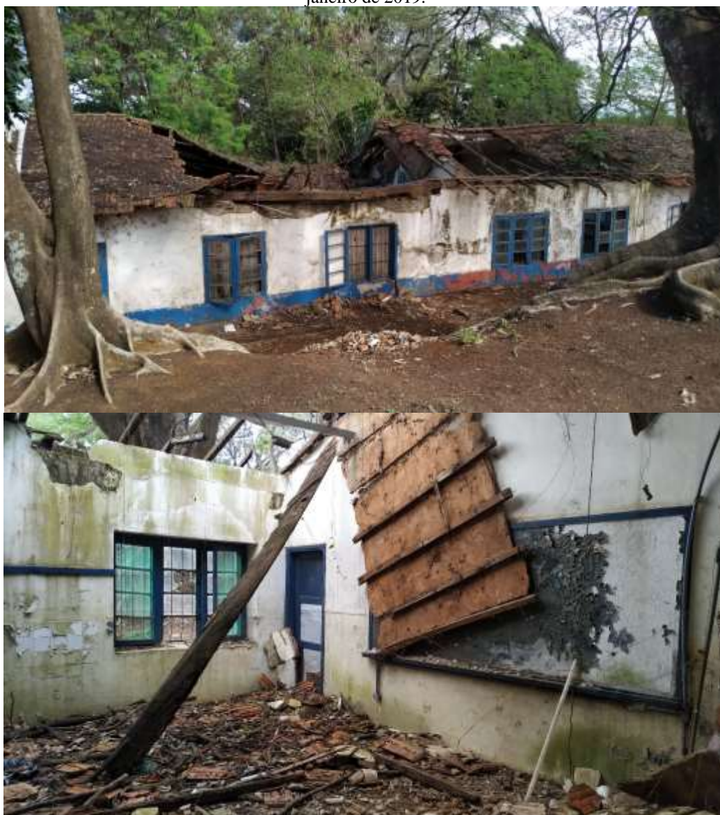
Figura 111 - Edifício da Escola São Paulo em arruinamento, com acúmulo de resíduos e descarte de lixo, em janeiro de 2019.
