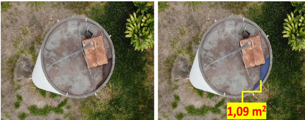
Figura 43: Ampliação da caixa de água da escola (esquerda). Medição da área das poças de água (direita).
