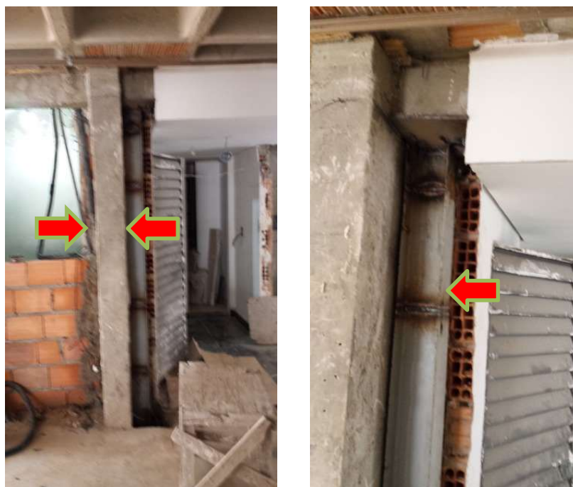
Fotos. 02 e 03: Pilar do Subsolo – Pilar em concreto com sessão original “íntegra” e instalação de pilar metálico posterior.
