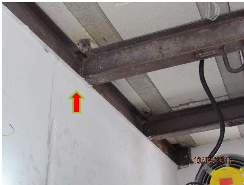
Foto. 01: Casa Máquina – Interface entre vigas metálicas e pilares em concreto executado posterior
