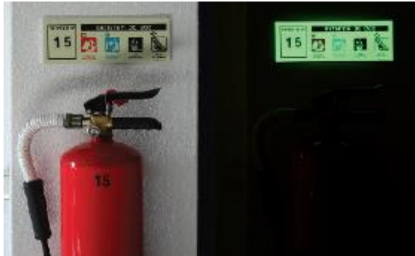
Figura 6: Sinalização complementar anexa ao extintor.
