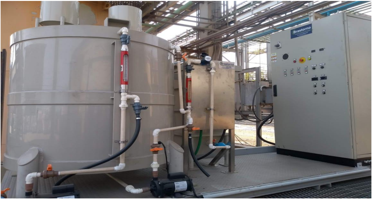
Figura 12 - Planta de tratamento de efluentes em funcionamento
