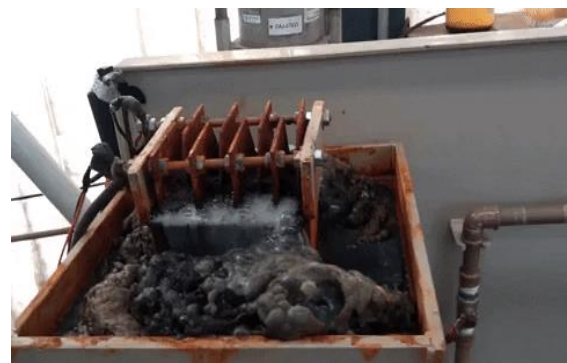
Figura 10 – Eletrofloculação em funcionamento
