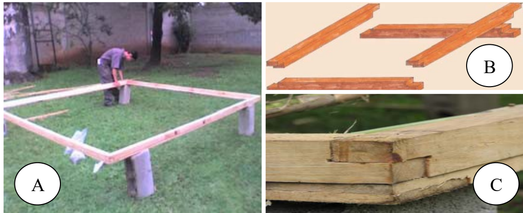
Figura 6 – Detalhe da estrutura de apoio da Cúpula Domocaña. Fontes: GÁLLIGO et. al. (2005); SANDOVAL (2008)
