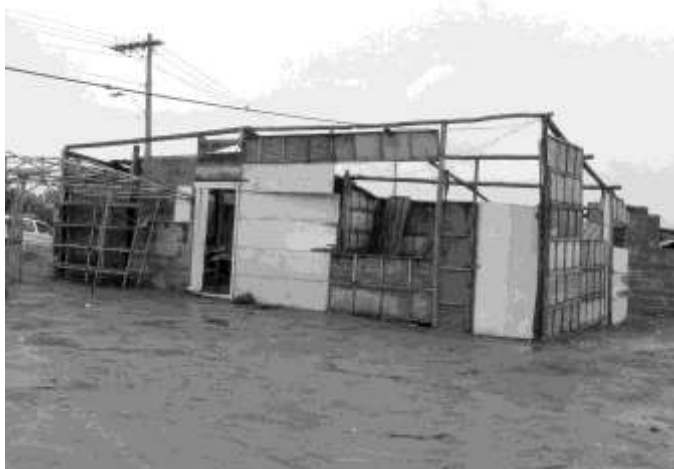
Figura 7: Antigo galpão comunitário danificado pelas chuvas de verão
