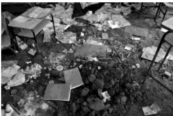
Figura 26: Sala do segundo pavimento da Escola Municipal de Paracatu de Baixo na visita do dia 7/7/2016 destruída pela lama da Samarco Fonte: Acervo GG.
