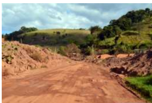
Figura 38: Taludes de lama na borda da estrada de acesso na entrada de Paracatu de Baixo na visita do dia 7/7/2016
