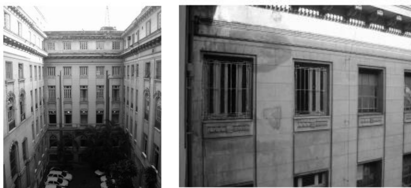
Figura 59 – Vista do pátio interno e detalhe das infiltrações nas janelas da Secretaria de Estado da Segurança Pública.
