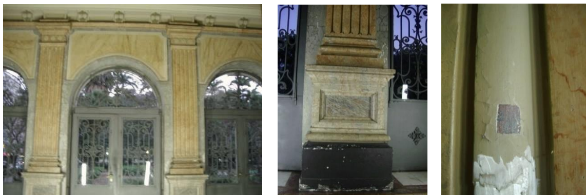
Figura 46 – Detalhe do estado de conservação do vestíbulo e de prospecções realizadas.
