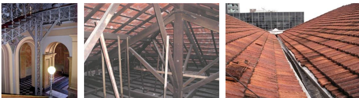
Figura 42 – À esquerda, interior da Secretaria e detalhe da estrutura de reforço da escada de ferro; à direita, detalhe do interior do telhado, entelhamento e calhas.
