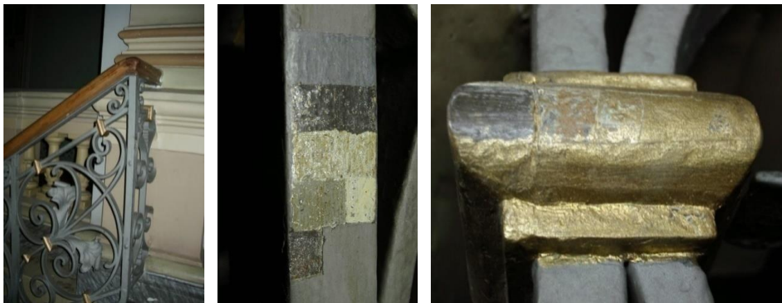
Figura 45– Detalhe das camadas de pintura da escadaria de ferro.
