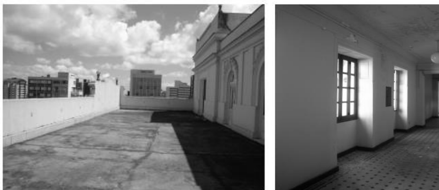
Figura 58 – Detalhe do terraço frontal e da área interna do 5º pavimento com manchas de infiltrações no teto e no piso em ladrilho hidráulico.
