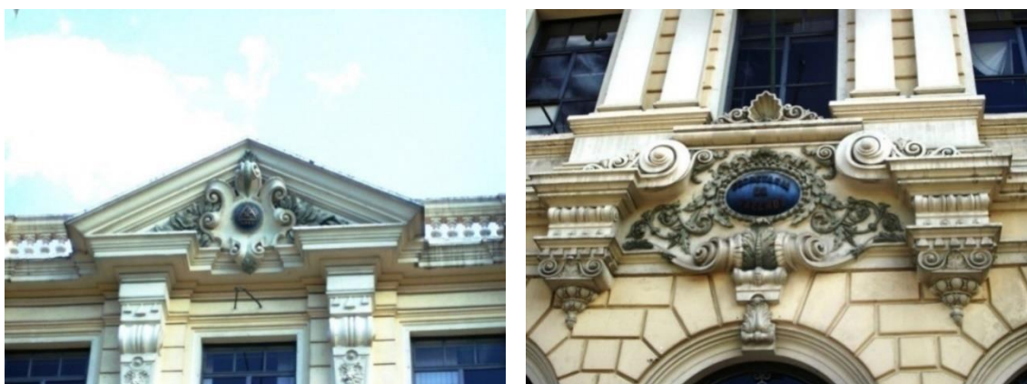
Figura 48 – Detalhe do estado de conservação do frontispício da fachada da secretaria.
