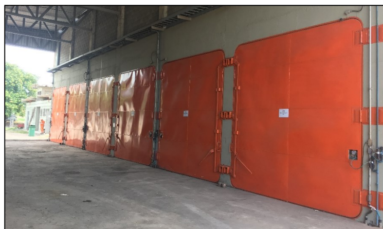
Figura 4.3: Vista frontal dos reatores MESB. Detalhe das portas herméticas e do pátio coberto para o recebimento e preparo do substrato.
