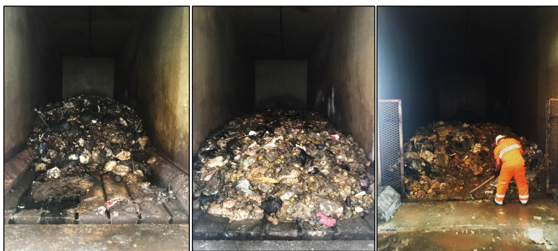
Figura 7.8: Formação de leira sem utilização de material estruturante (esq.), escoamento do resíduo para frente do reator MESB (centro) e obstrução da drenagem interna (dir.).
