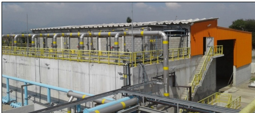
Figura 4.2: Vista geral da TMethar. Detalhe da infraestrutura dos reatores MESB construídos em concreto armado e tubulações de inox para a coleta de biogás.
