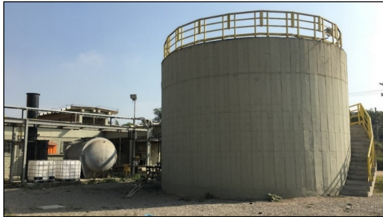
Figura 4.4: Vista geral do reator anaeróbio de mistura completa para a estabilização biológica do lixiviado e produção de inóculo - Unidade de Produção de Inóculo (UPI)
