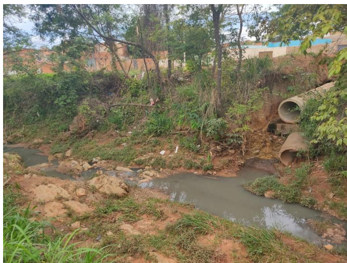
Figura 7. Leito do Córrego Vargem Grande na chuva.
