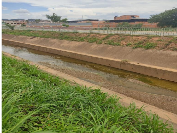
Figura 11. Leito do Córrego Vargem Grande na chuva.
