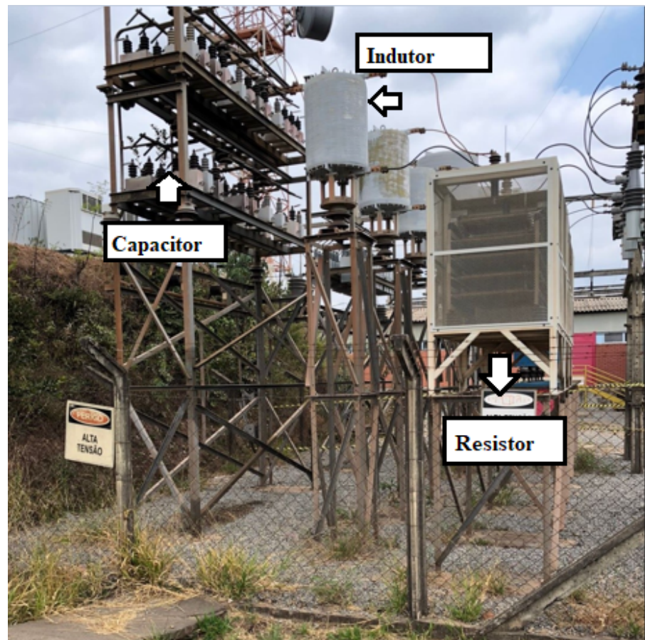
Figura 39 – Filtro Passivo 2,56 MVA r desativado.
