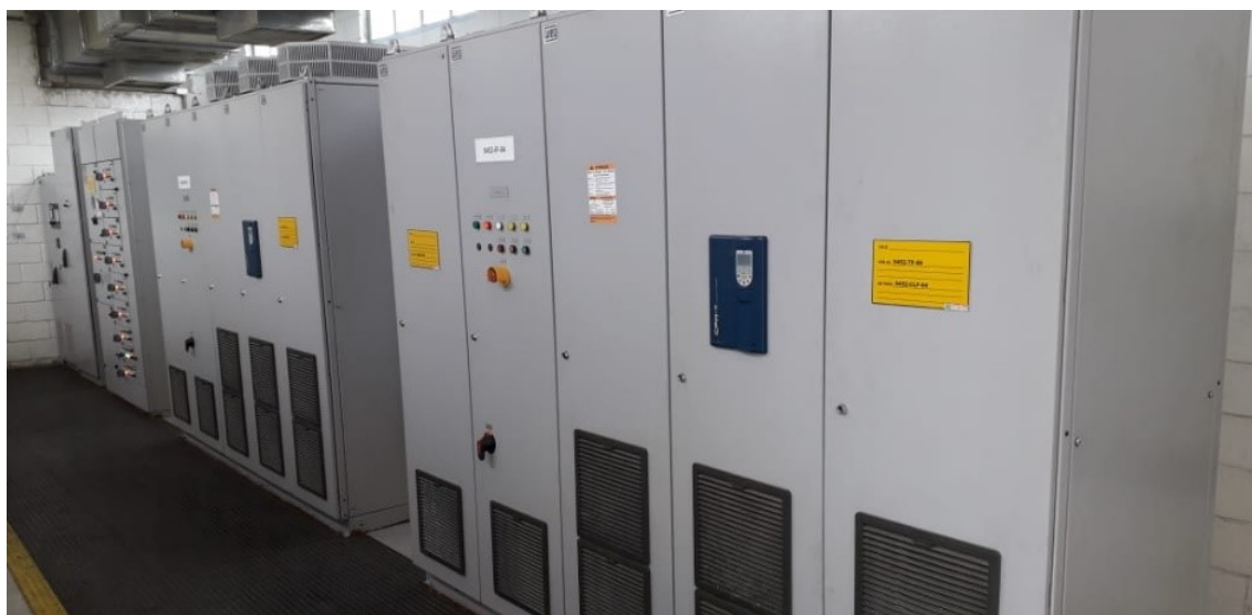
Figura 42 – Foto do Inversor WEG 12 pulsos.
