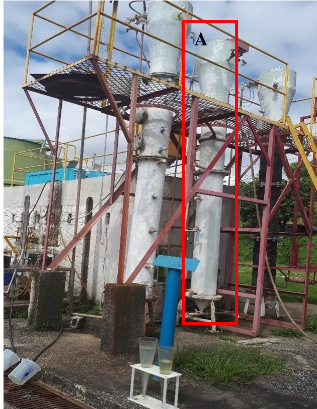
Figura 4.1.1 Reatores UASB localizados no CEPTS como pré-tratamento anaeróbio para o RBS laboratorial
