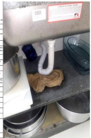
Foto cozinha – cano vazando (defeito)
