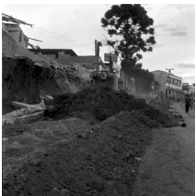
Av. Havaí serviço de terraplanagem – S/D. Obras na Avenida Havaí. Serviço de terraplanagem. APCBH/ASCOM
