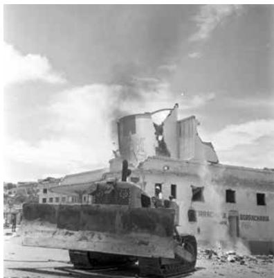
Demolição Edificação Porto Noechi na Praça Vaz de Melo Lagoinha, S/D. APCBH/ASCOM
