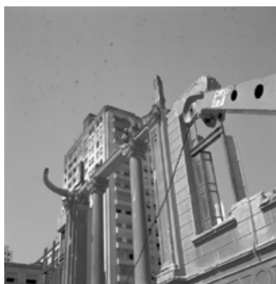
Demolição da Delegacia Fiscal. Avenida Afonso Pena com Alvares Cabral, 1969. Laboratório de Foto-Documentação Sylvio de Vasconcellos.
