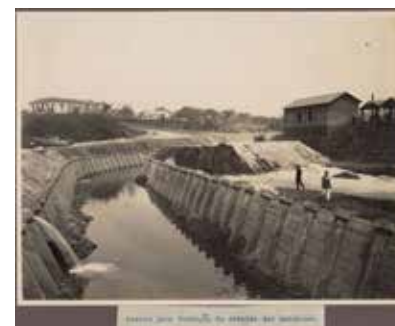
Canalização do Arrudas no cruzamento com a Avenida do Contorno, entre 1926-1930. Fundo OM, APM
