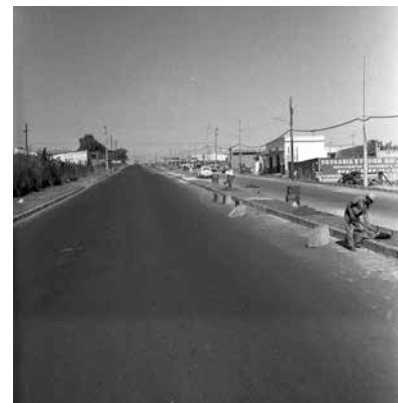
Obras diversas: Asfalto e Arborização – jun – 1975. Rua Magalhães Penido. Bairro Pampulha. 1975/06. ASCOM/APCBH
