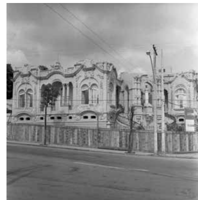
Demolição de Casa na Avenida João Pinheiro, esquina com Rua Timbiras. / 1970. PCBH/ASCOM
