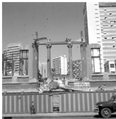
Demolição da Delegacia Fiscal. Avenida Afonso Pena com Alvares Cabral, 1969. Laboratório de Foto-Documentação Sylvio de Vasconcellos.
