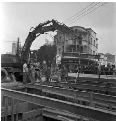
Prefeito visita obras do Córrego do Leitão. Avenida Augusto de Lima esquina com Rua Padre Belchior. APCBH/ASCOM
