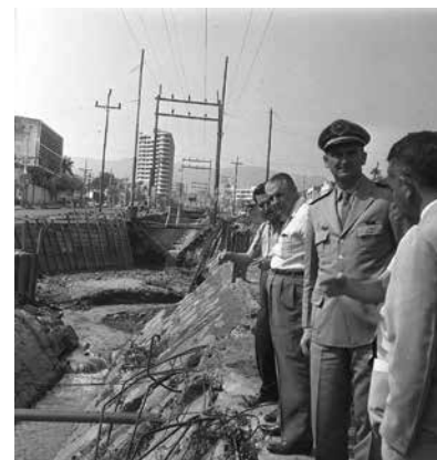
Prefeito visita diversas obras de PBH – setembro de 1965. Prefeito Oswaldo Pieruccetti visita obras na Avenida Afonso Pena. APCBH/ASCOM
