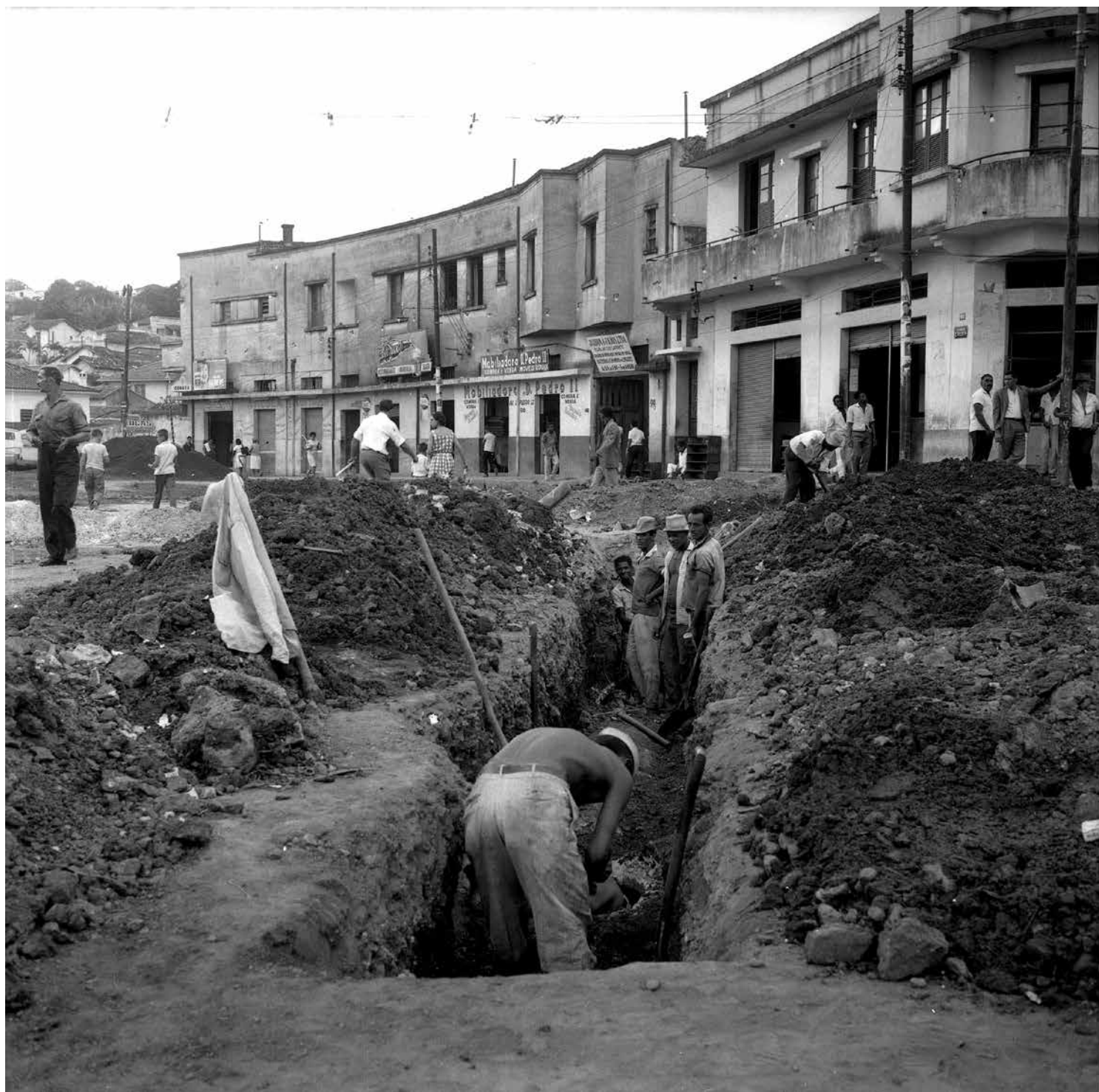
Identificação original Obras das ruas Mauá e Rio Preto 14 de fevereiro de 1963 Fotógrafo não identificado Obras na rua Mauá (posteriormente, Avenida Nossa Senhora de Fátima) Gestão Jorge Carone Filho Fundo da Assessoria de Comunicação Social do Município - ASCOM (1947-2015) Identificação: 2729 ASCOM/APCBH Arquivo Público da Cidade de Belo Horizonte/ Fundação Municipal de Cultura
