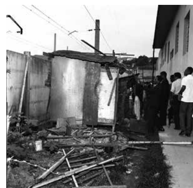
DBP impede novas construções de barracas, festas de natal do D.I. Funcionários do Departamento de Habitação e Bairros Populares - DBP desmantelam abrigos e moradias em ação de "desfavelamento". APCBH/ASCOM
