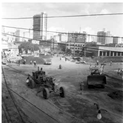
Obras – S/D Rua Paulo de Fronten. Edifício Minas Brasil (o maior ao fundo). APCBH/ASCOM
