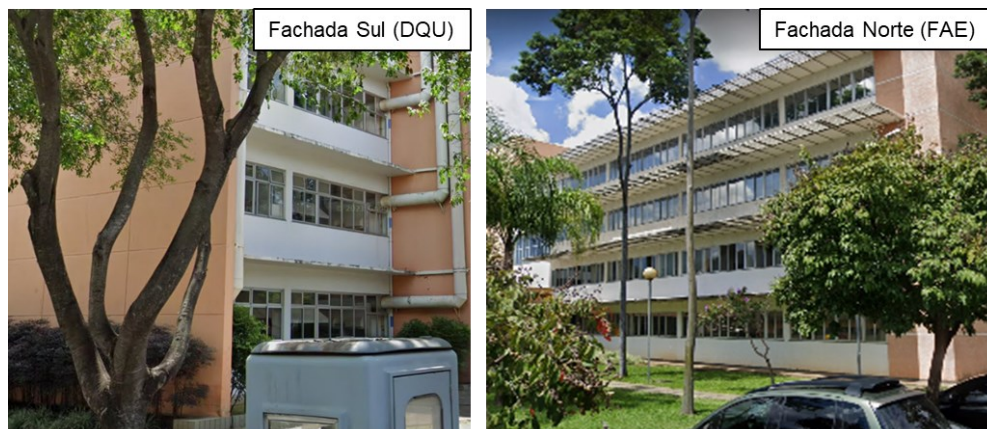
Figura 45 - Exemplos de proteções solares tipicamente encontrados nos campi da UFMG em Belo Horizonte
