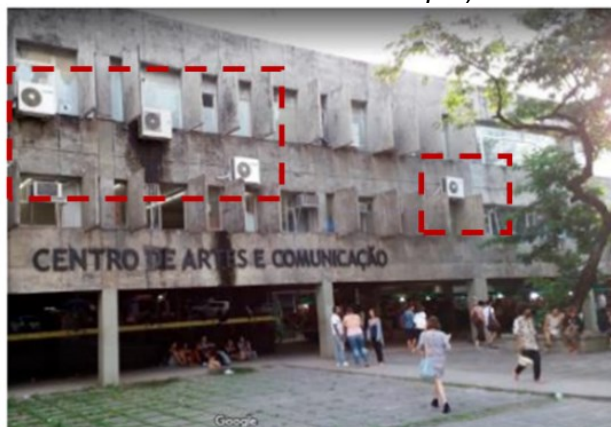
Figura 28 - Exemplo de identificação do tipo de condicionamento de ar: tipo misto (unidades de ar-condicionado split )
