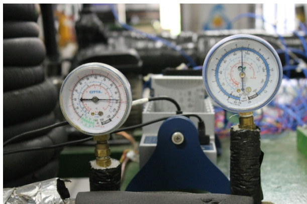
Figura 22: Manômetros na saída do condensador e entrada da microbomba.
