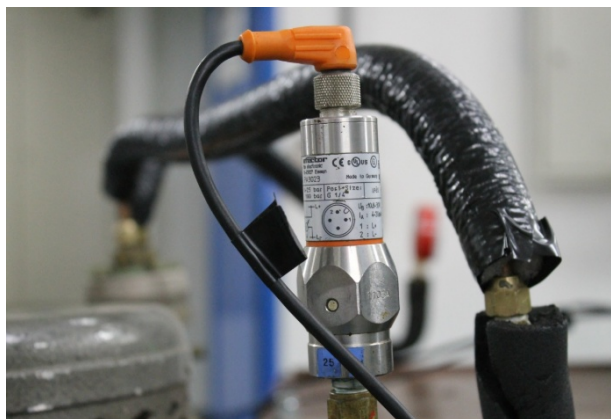
Figura 21: Transdutor na saída do aquecedor.
