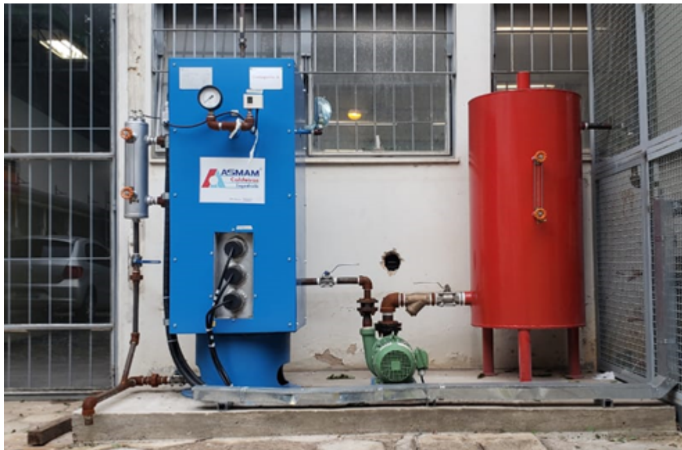
FIGURA 3.7: : Sistema de produção de água quente e de vapor do banco de testes.
