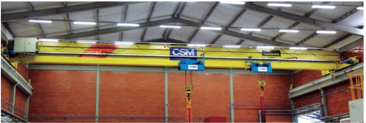
Figura 18 - Ponte rolante uni-viga.
