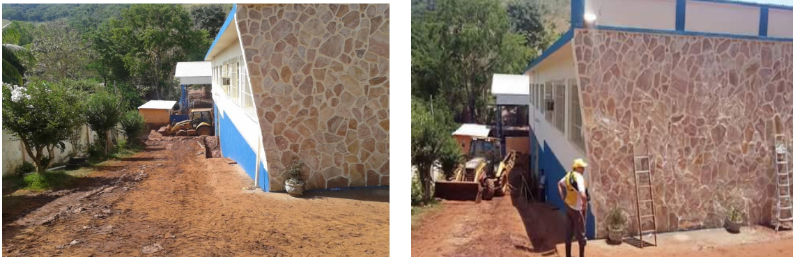
Figura 8 – Rampa de acesso à parte baixa da escola e ao final, máquina retirando lama.
