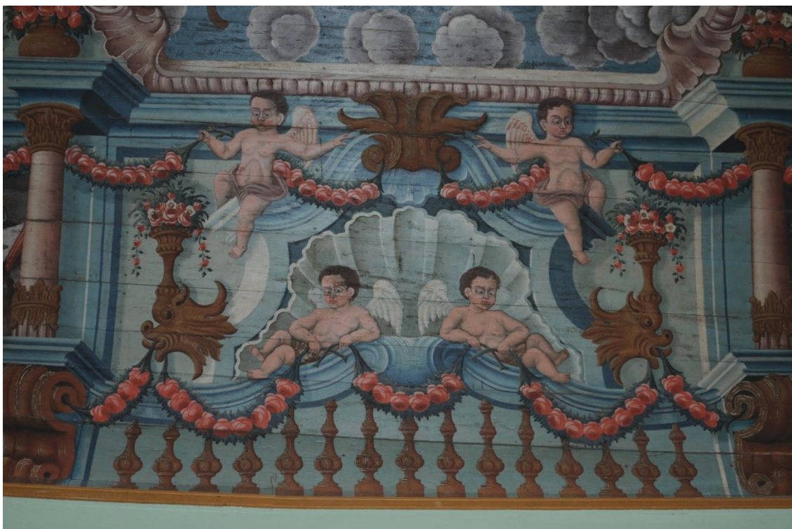
Figura nº 57: Igreja de São Gonçalo em São Gonçalo do Rio das Pedras. Serro. Detalhe. Foto: Eduardo Orlando
