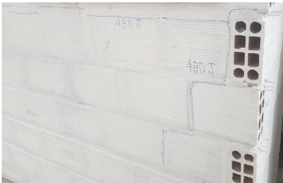
Figura 107 – Fissuras no lado frontal da alvenaria e à direita após o impacto de 480 J
