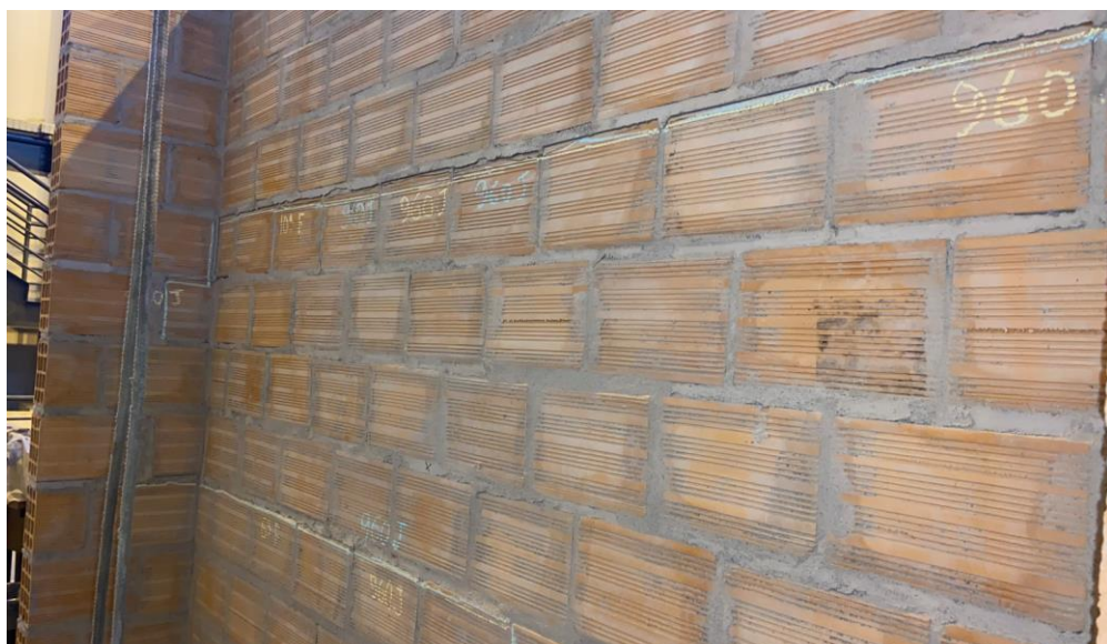
Figura 73 – Vista frontal para a esquerda da segunda alvenaria tipo ALV - 3
