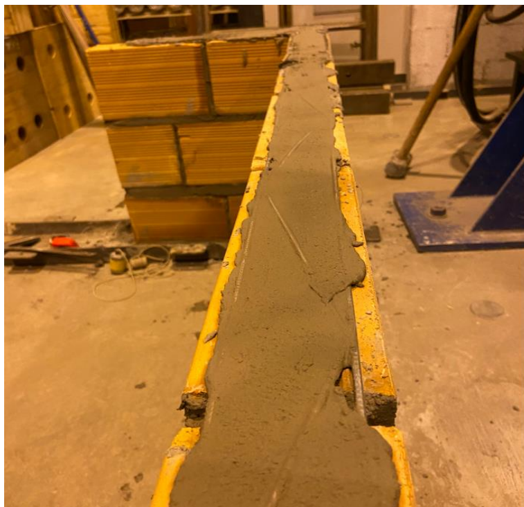
Figura 39 – Colocação da treliça plana aramada no eixo médio da junta de assentamento horizontal
