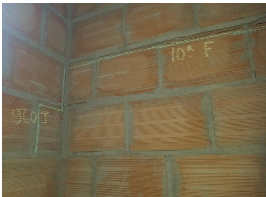
Figura 77 – Vista para a fissura propagada para o lado posterior
