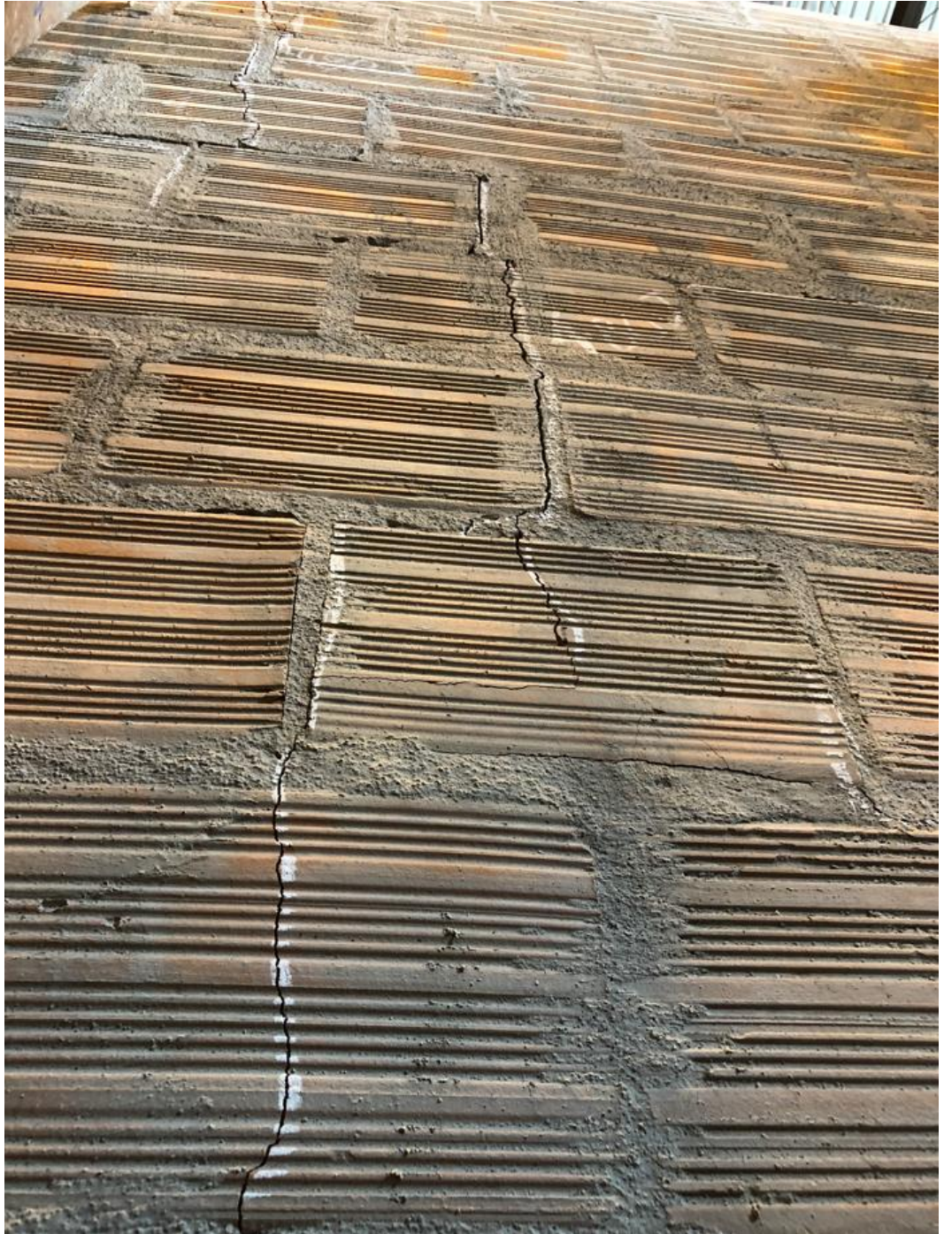
Figura 53 – Detalhe da fissura apresentada na ALV – 1 do topo até à base
