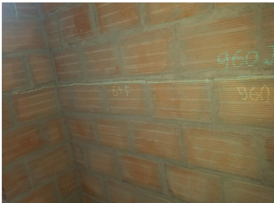
Figura 74 – Vista para a fissura apresentada na junta horizontal da 6ª fiada
