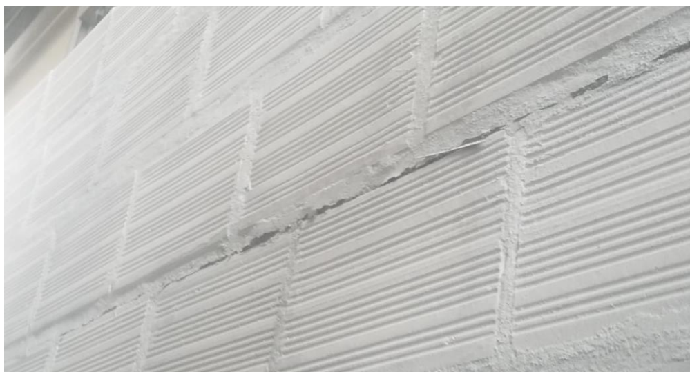
Figura 101 – Deslocamento lateral da alvenaria localizado no lado posterior da alvenaria em vista ampliada
