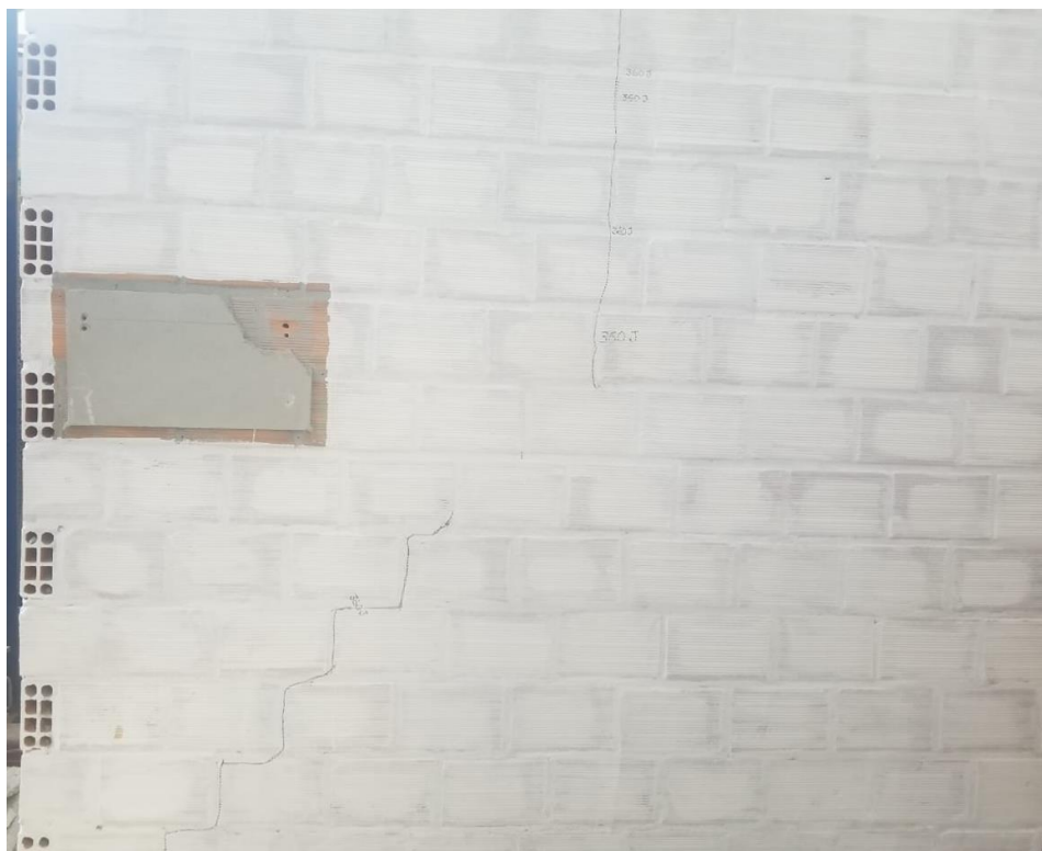
Figura 56 – Vista frontal da ALV – 2 com o mapeamento das fissuras
