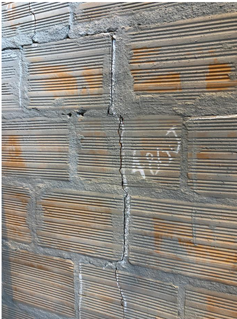
Figura 54 – Detalhe da fissura na ALV – 1 após o impacto de 480 J
