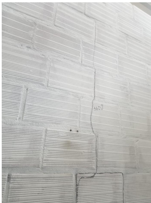
Figura 59 – Detalhe da fissura apresentada na ALV – 2 desde o topo até ao meio da parede
