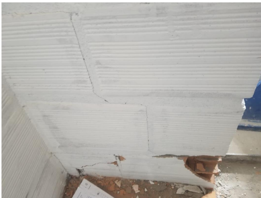
Figura 112 – Ruína na parede lateral da segunda ALV- 6 após o impacto de 720 J
