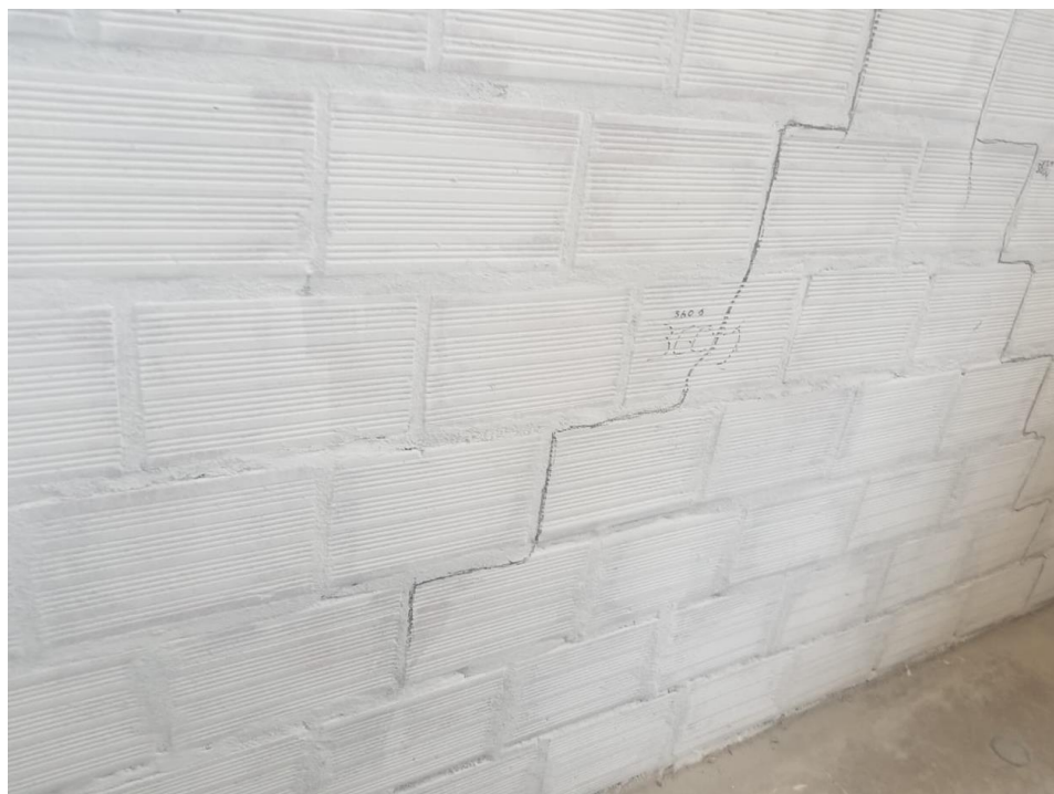
Figura 61 – Detalhe da fissura apresentada na ALV – 2 do meio em direção à lateral inferior esquerda
