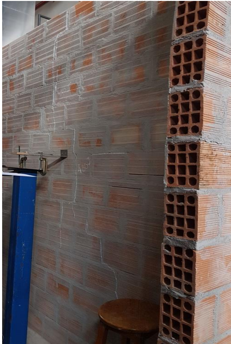
Figura 50 – Vista da região côncava da ALV – 1 com o mapeamento das fissuras
