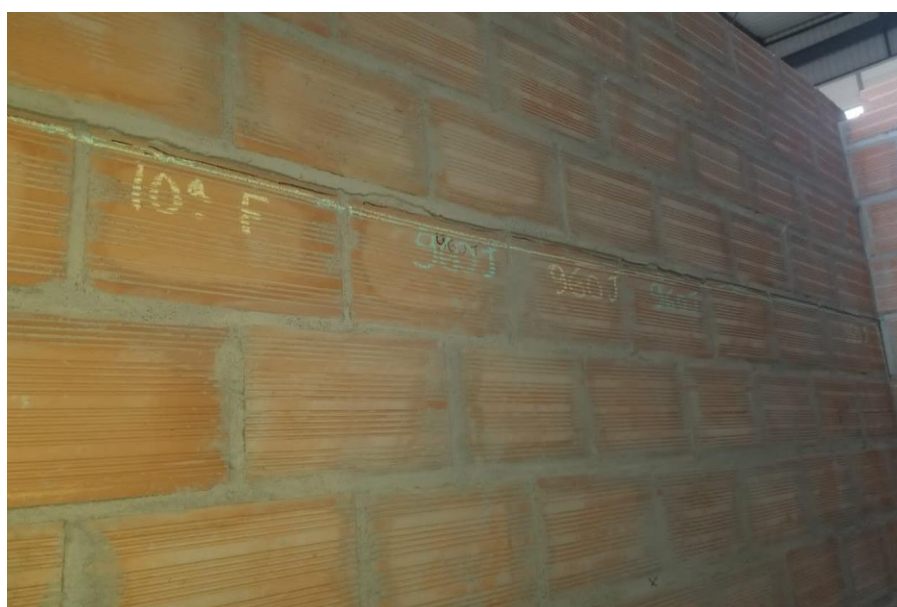
Figura 75 – Vista posterior para a fissura apresentada na junta horizontal da 10ª fiada
