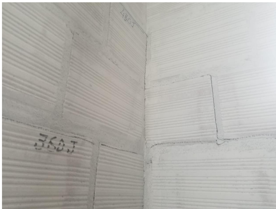
Figura 98 – Fissuras localizadas no lado posterior da alvenaria à esquerda com vista ampliada
