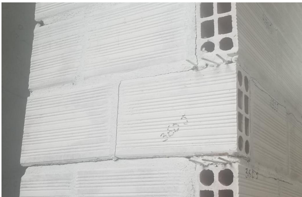
Figura 96 – Fissura lateral localizada à esquerda da alvenaria
