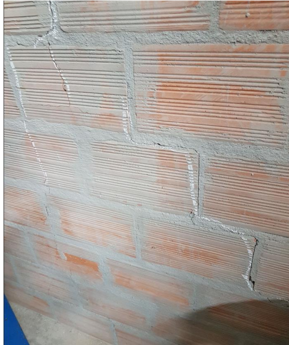
Figura 51 – Detalhe da fissura apresentada na ALV – 1
