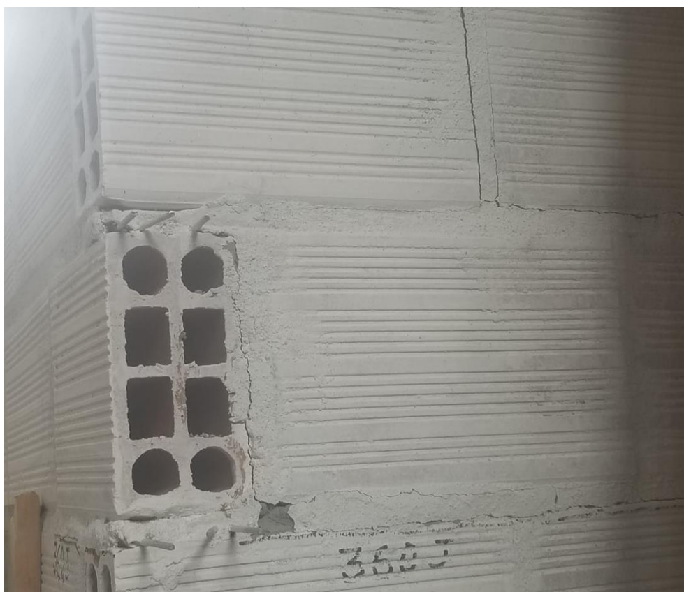
Figura 97 – Fissura frontal localizada à esquerda da alvenaria
