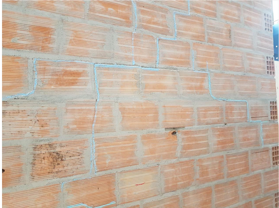
Figura 49 – Vista frontal da ALV – 1 com o mapeamento das fissuras
