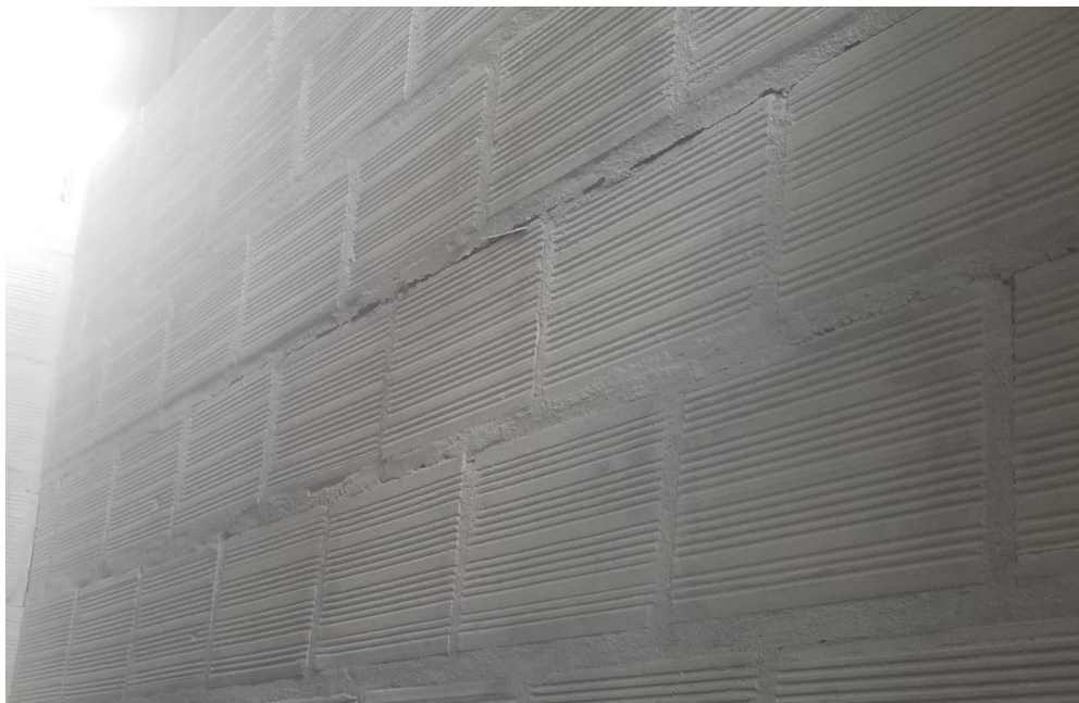
Figura 100 – Deslocamento lateral da alvenaria localizado no lado posterior da alvenaria
