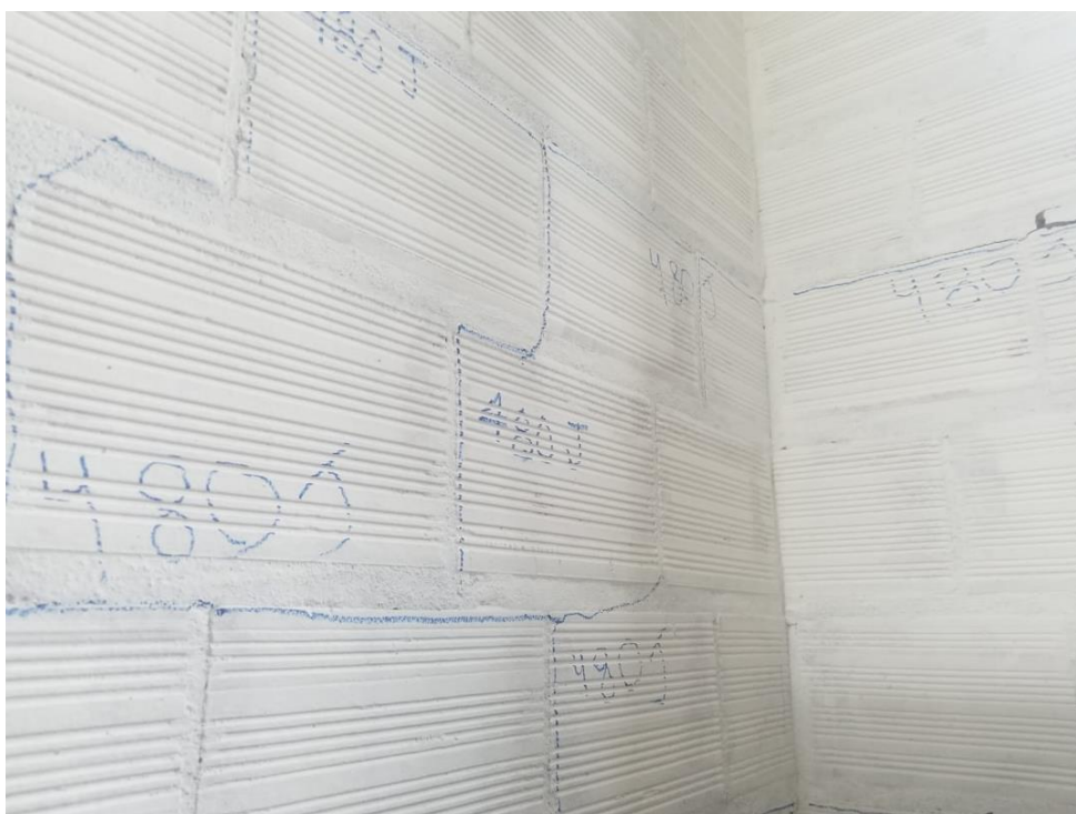
Figura 108 – Fissuras no lado posterior da alvenaria à direita após o impacto de 480 J
