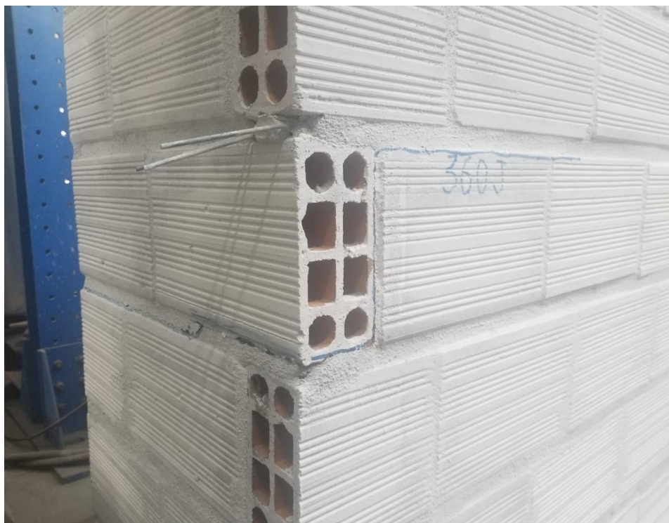
Figura 86 – Ocorrência de fissura localizada no canto esquerdo frontal da alvenaria
