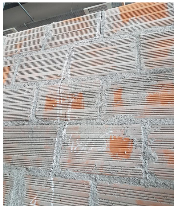
Figura 52 – Detalhe da fissura apresentada na ALV – 1 desde o topo até o meio
