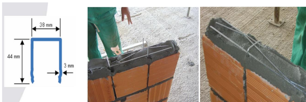
Figura 26 – Treliça plana aramada encaixada no grampo com o uso de argamassa convencional
