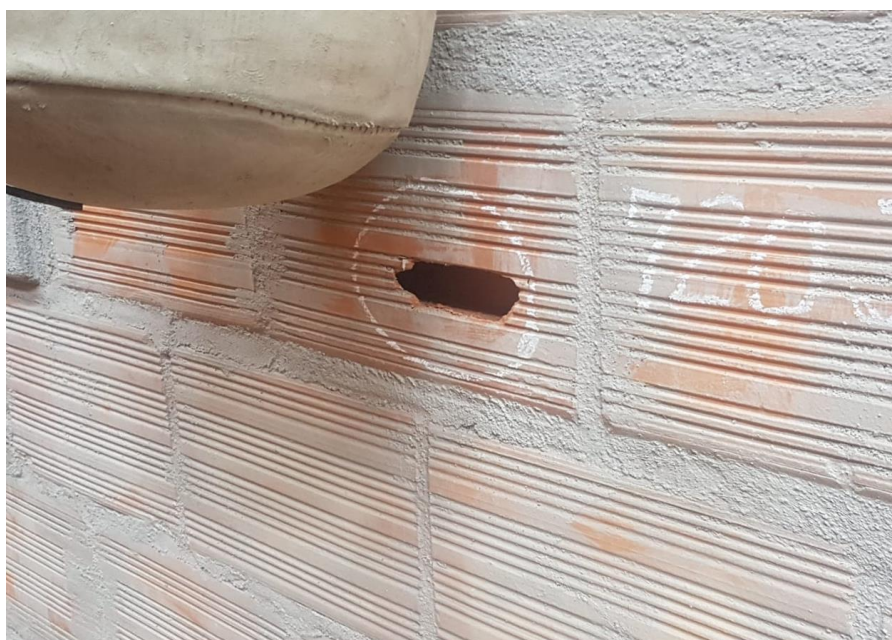
Figura 65 – Ruptura localizada no bloco após impacto de 720 J em destaque
