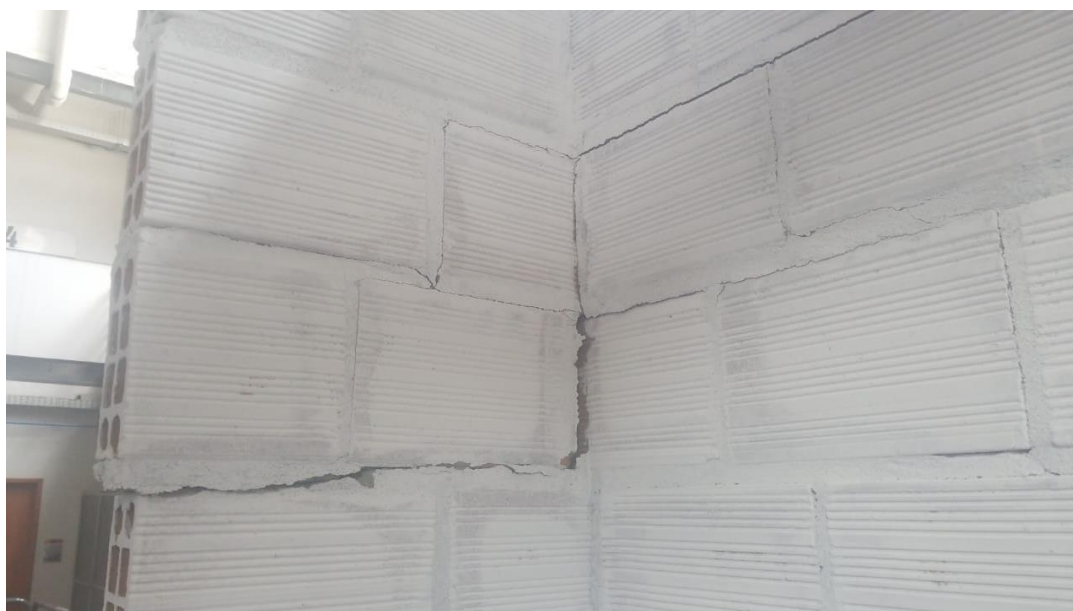
Figura 90 – Deslizamento da alvenaria na direção da sua própria junta horizontal com a vista interna
