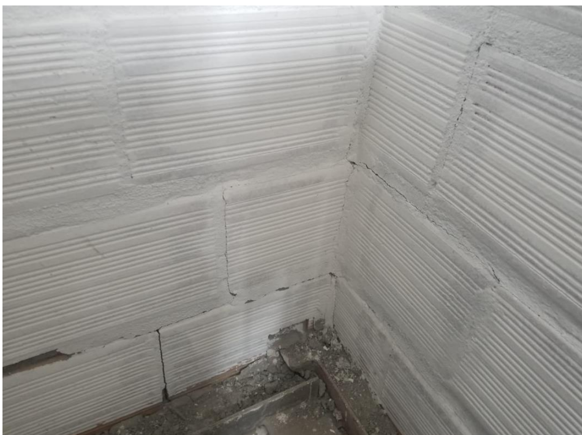
Figura 111 – Ruína no lado posterior da segunda ALV- 6 após o impacto de 720 J
