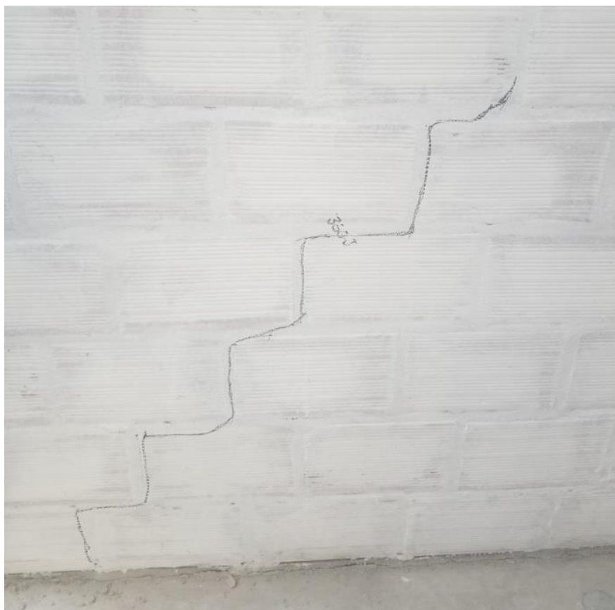
Figura 58 – Detalhe da fissura apresentada na ALV – 2
