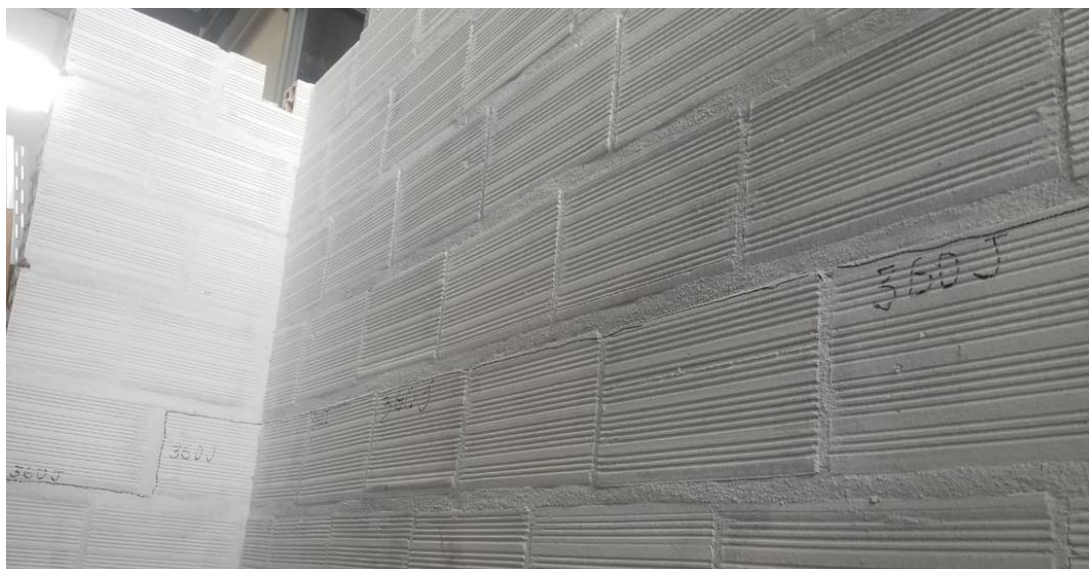
Figura 105 – Fissuras localizadas no lado posterior da alvenaria e à esquerda
