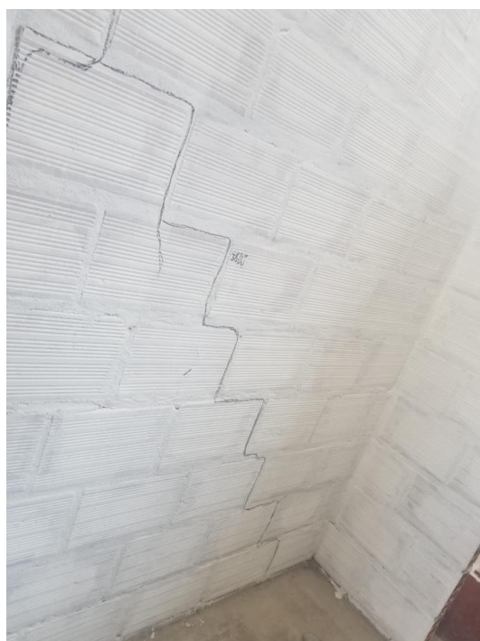
Figura 60 – Detalhe da fissura apresentada na ALV – 2 do meio em direção à lateral inferior direita
