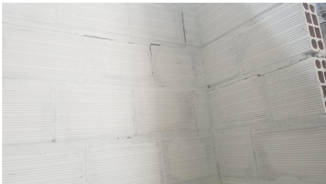
Figura 87 – Vista posterior da alvenaria, com destaque para as fissuras após o impacto de 360 J
