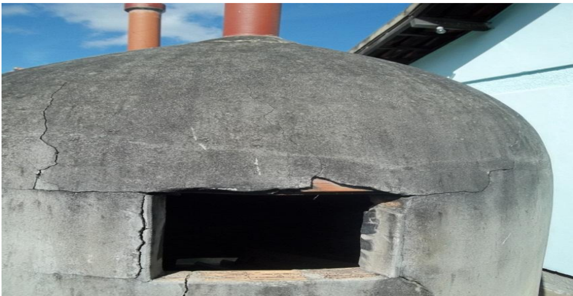
Figura 9 – Incinerador desativado no pátio do hospital. Novembro de 2011.
