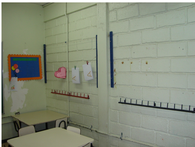
FOTO 11: SALA DE AULA XXXX – PAREDE VAZIA
