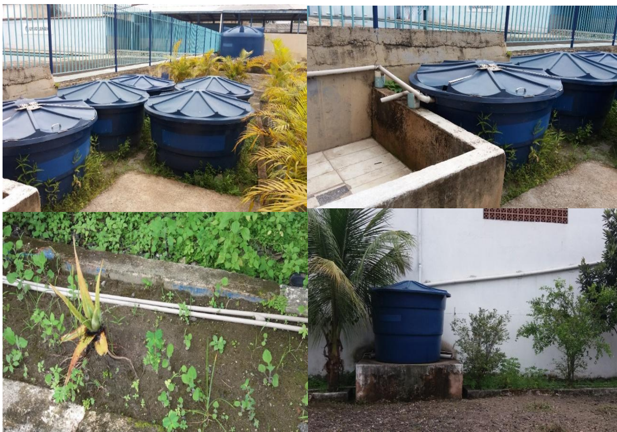
Figura 30. Sistema de Aproveitamento de Água do Colégio Aplicação Unigranrio – Santa Cruz da Serra.
