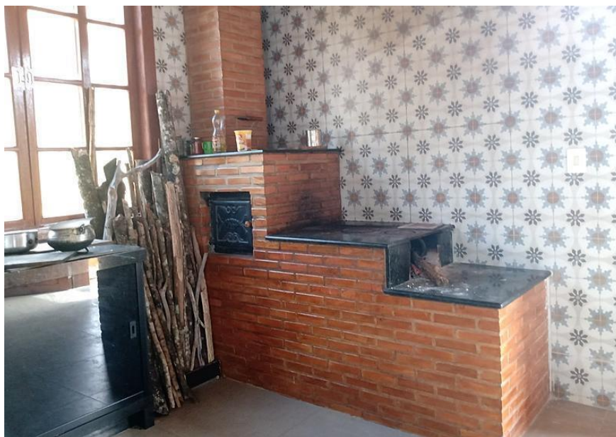
Imagem 15. Fogão pré-moldado com defeitos instalado na casa de dona Maria Auxiliadora, em Paracatu de Cima / Foto: Arquivo Cáritas MG. Brasil de Fato, abril/2022.
