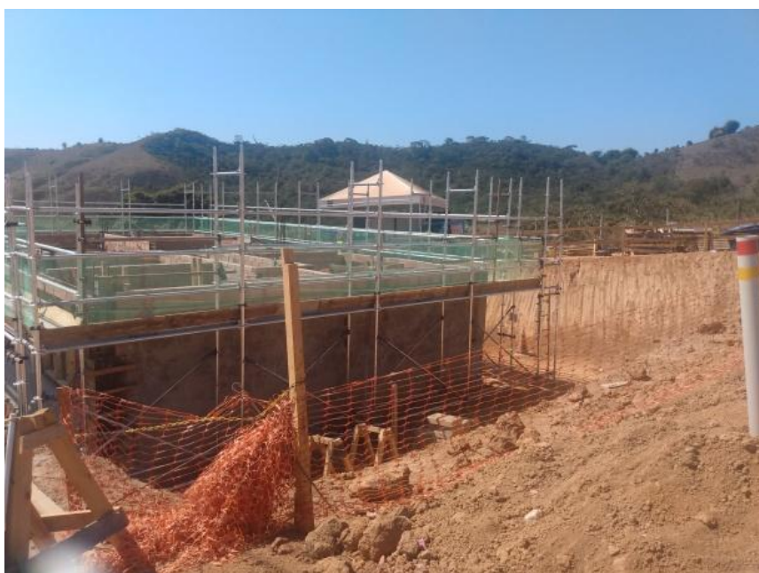
Imagem 12. Terreno onde está sendo construída a casa de Ad. Foto: Maryellen Milena de Lima, 05/08/22.
